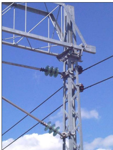
Figur 3-8 Returledere hengt opp i kontaktledningsmast [12]
