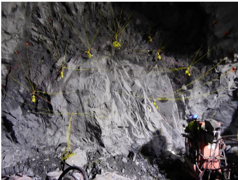
Figur 20 Salve med blokking i Eiganestunnelen
