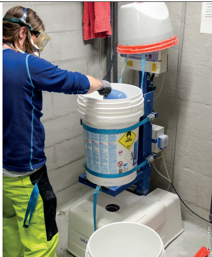
Påfylling av klor ved Husebybadet
