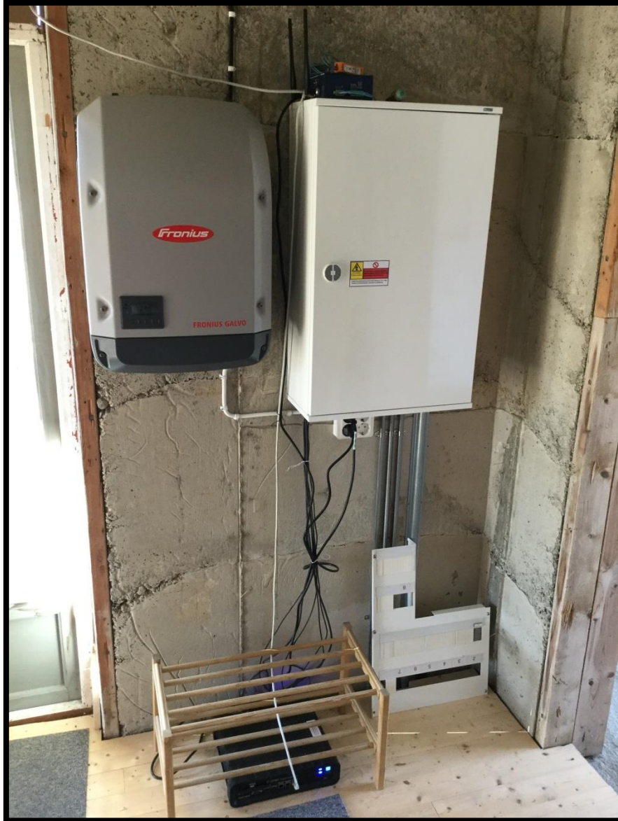
Figur 40 Sikringsskap og inverter plassert i andre etasje av bygget. Her ser vi også G4500 Blackbox som er benyttet til innsamling av data. På toppen av sikringsskapet står GSM-ruteren som overfører data til NTEs hovedkontor på Steinkjer.
