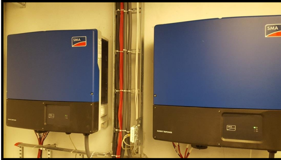
Figur 43 Vekselretterne er lokalisert i skolens tekniske rom. Her henger en på 20 kWp og en på 25 kWp
