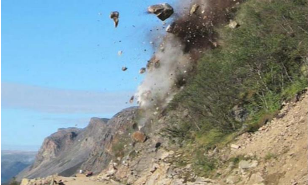
Figur 2.19: Steinsprang mot veg i forbindelse med rensk av fjellside (Schanche, 2014).
