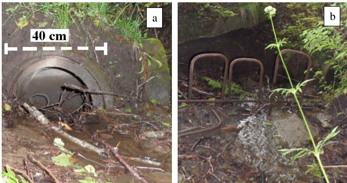
Figur 5.21: Utilstrekkelig vedlikeholdt stikkrenne i studieområdet: a) Halve stikkrennen er fylt opp med sedimenter, og den har to innløp som begge har en indre diameter på 40 cm. 10 cm inn fra åpningen smalner begge innløp inn til å ha en diameter på 30 cm. b) Sedimentasjonsrister for oppfangning av materiale lokalisert 1 m oppstrøms for stikkrennen. To rister er veltet, hvor den ene blokkerer de tre gjenværende ristene. Sedimenter som har blitt oppsamlet har ikke blitt fjernet (Begge foto: Marte Bakka Stemland, 14.07.2015).
