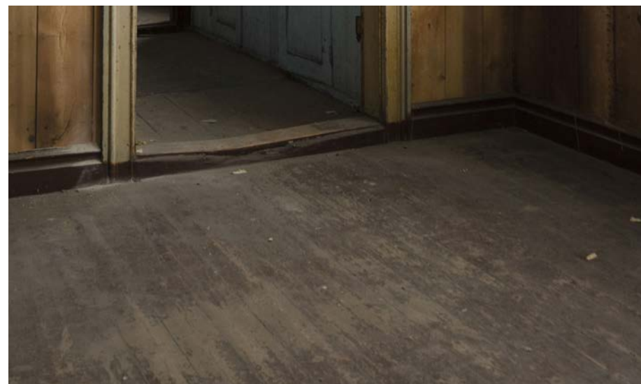
Bakkegata 1A, Trondheim; Bakgårdsbygning: Tydelig historie fra 120 år med slitasje.
