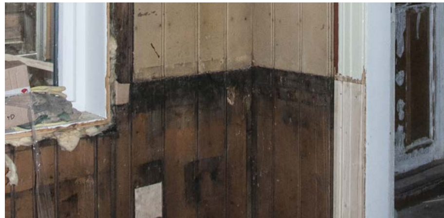
Skader og reparasjoner av vegg og karm. Husk at hvordan skader i overflaten repareres også har påvirkning på sluttresultatet.
