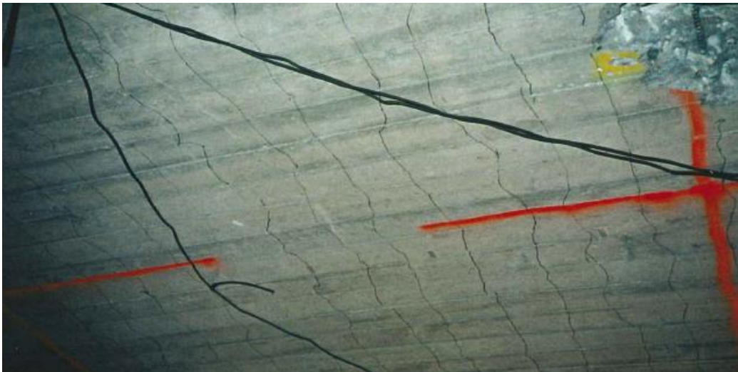
Figur 45: Riss som hadde oppstått før forsøket i underkant. Senteravstanden var 150 mm, altså lik avstanden på tverrarmeringen.
