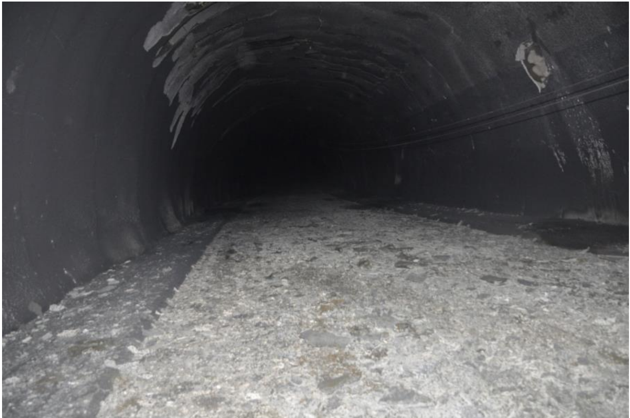
Figur 7.21 Betongavskalling og sotete vegger i Skatestraumtunnelen. Bildet er tatt rett etter brannen (Fotograf: Petter Hole)
