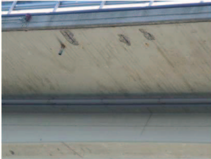
Figur 4.13: Delaminering og korroderende armering i underkant av plate i hovedfelt [21]
