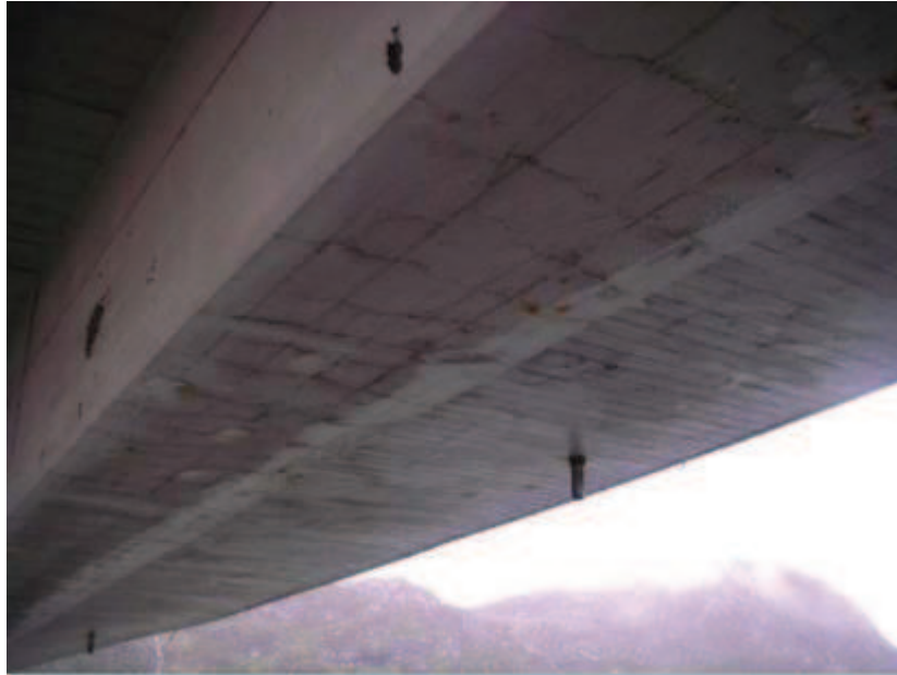
Figur 4.14: Tversgående riss i hovedfelt [21]
