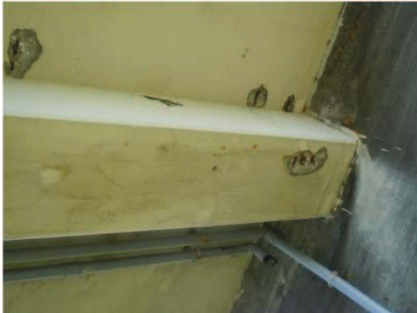
Figur 4.11: Delaminering og korroderende armering ved landkar akse 1 [21]
