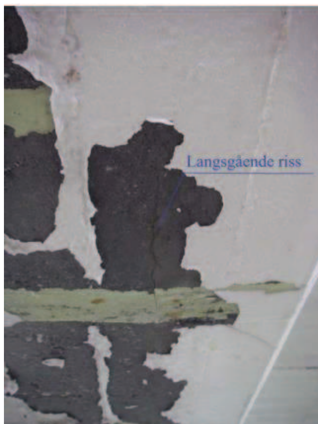
Figur 4.17: Langsgående riss i akse 3-4 [21]
