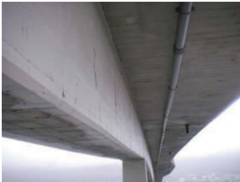
Figur 4.15: Tversgående riss i akse 8-9 [21]
