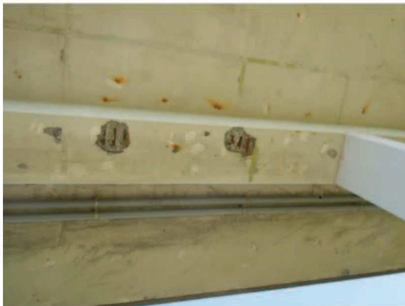
Figur 4.12: Delaminering og korroderende armering ved akse 2-3 [21]
