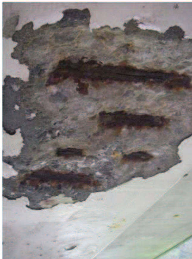
Figur 4.18: Korroderende bøylearmering i akse 3-4 [21]
