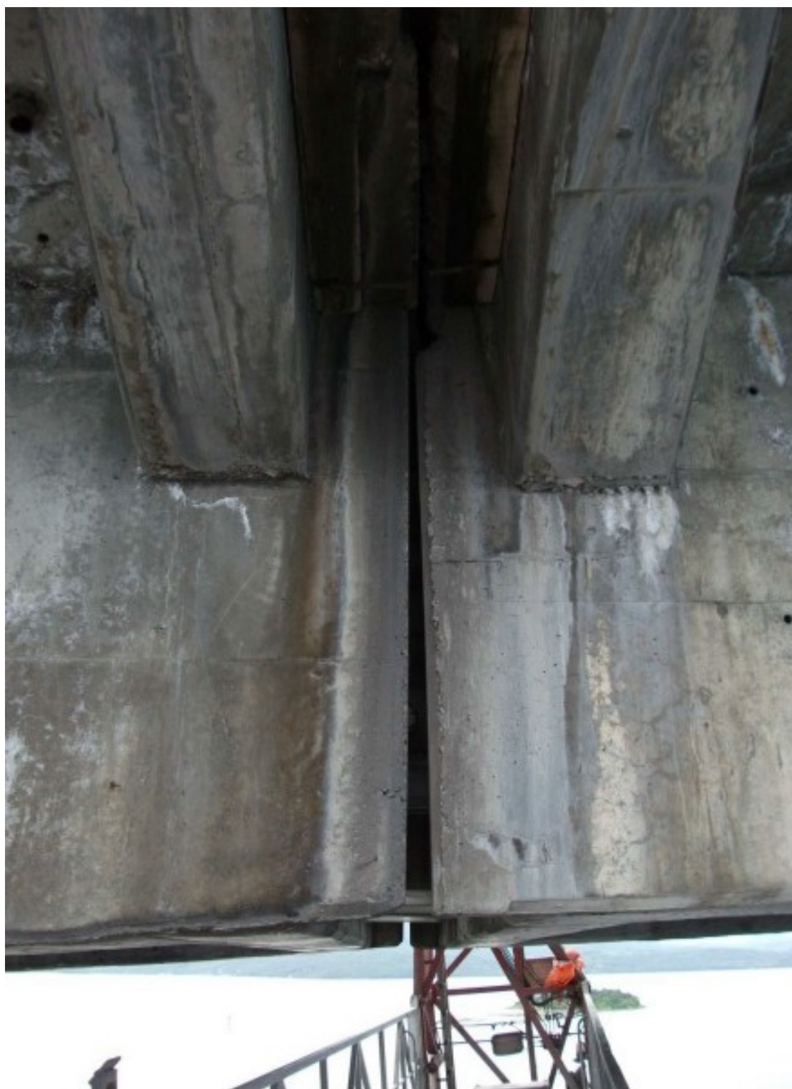
Figur 4.2: Fugespalte midtspenn akse 11 og 12. Her er åpningen målt til 6cm i bunn.
