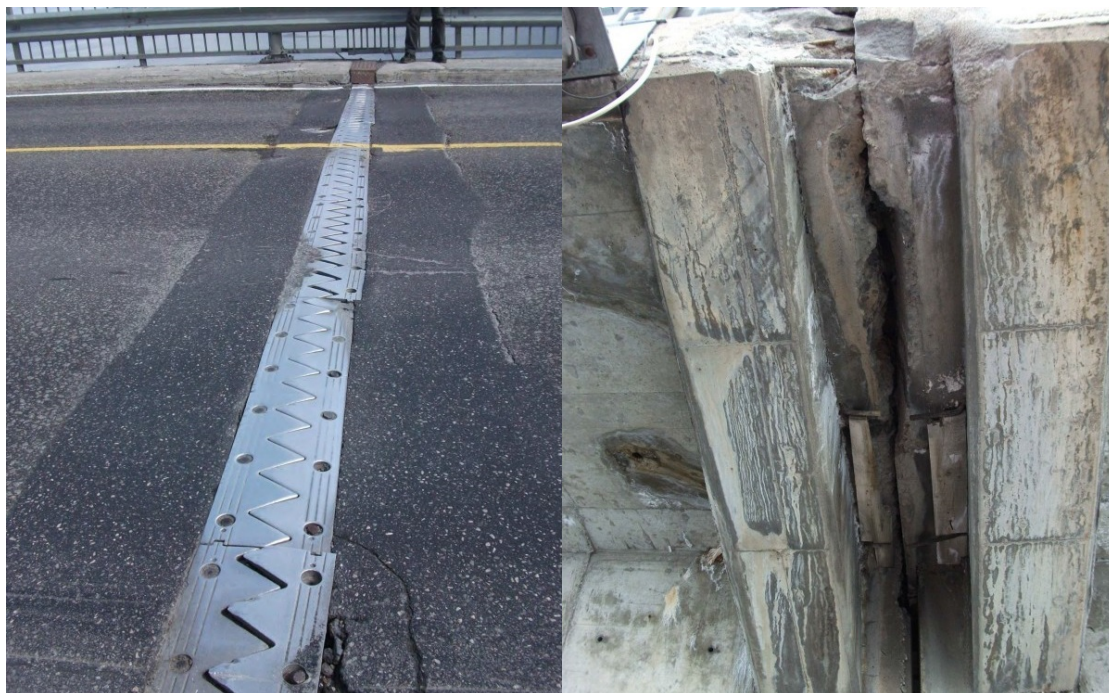
Figur 4.3: Venstre: Skader på fugen mellom akse 11 og 12. Høyre: Samme fuge sett fra undersiden. Tydelige betongskader i møte mellom kragplatene
