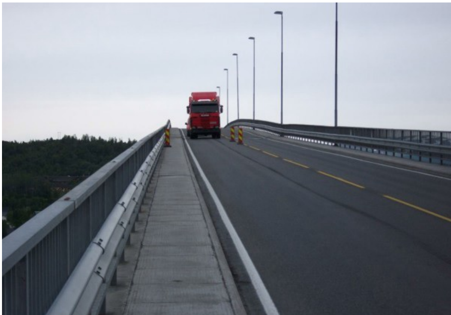
Figur 4.1: Nedbøyning i hovedspennet mellom akse 11 og 12 sett mot Silsand. Knekk inn mot fugen fremgår ved vegmerkingen.
