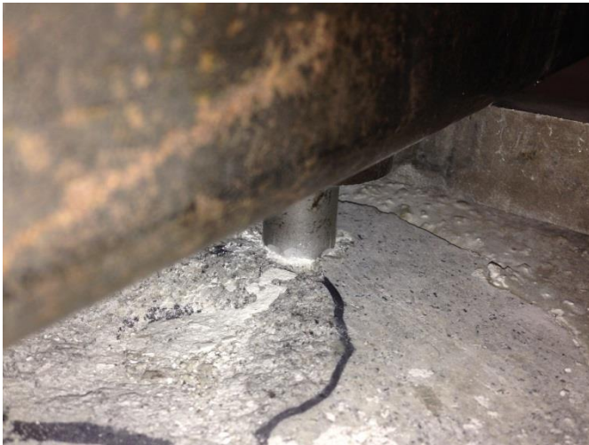
Figur 5.10: Avskallinger etter 6 slag
