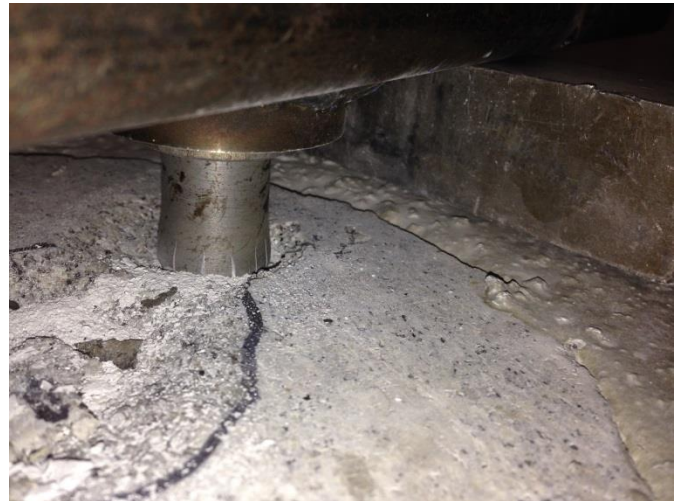
Figur 5.11: Tydelige sprekker etter 35 slag
