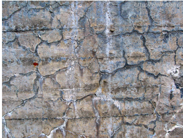
Figur 4.4: Typisk krakelermønster på en betongkonstruksjon utsatt for alkalisilika-reaksjon
