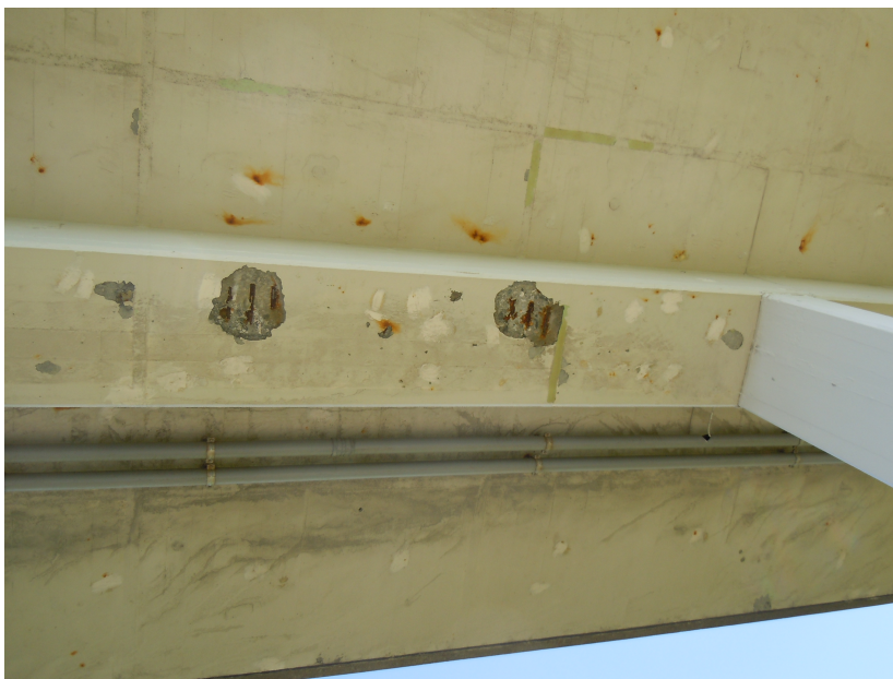
Figur 5.9: Delaminering og korroderende armering ved akse 2-3
