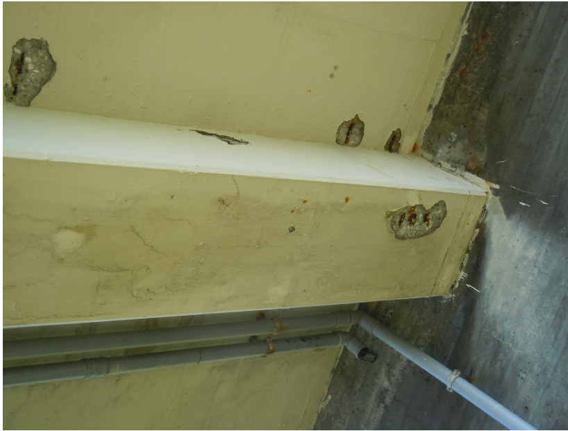
Figur 5.8: Delaminering og korroderende armering ved landkar akse 1
