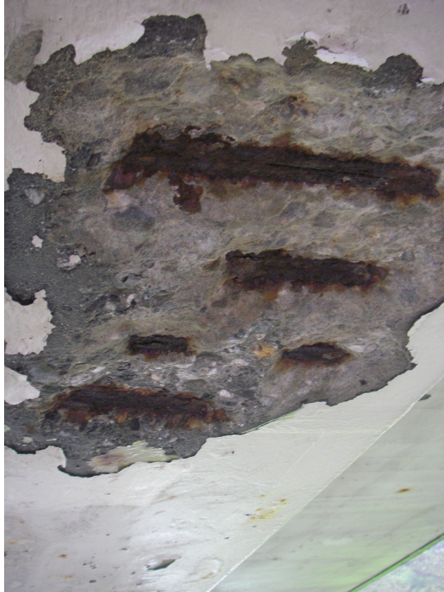
Figur 5.15: Korroderende bøylearmering i akse 3-4
