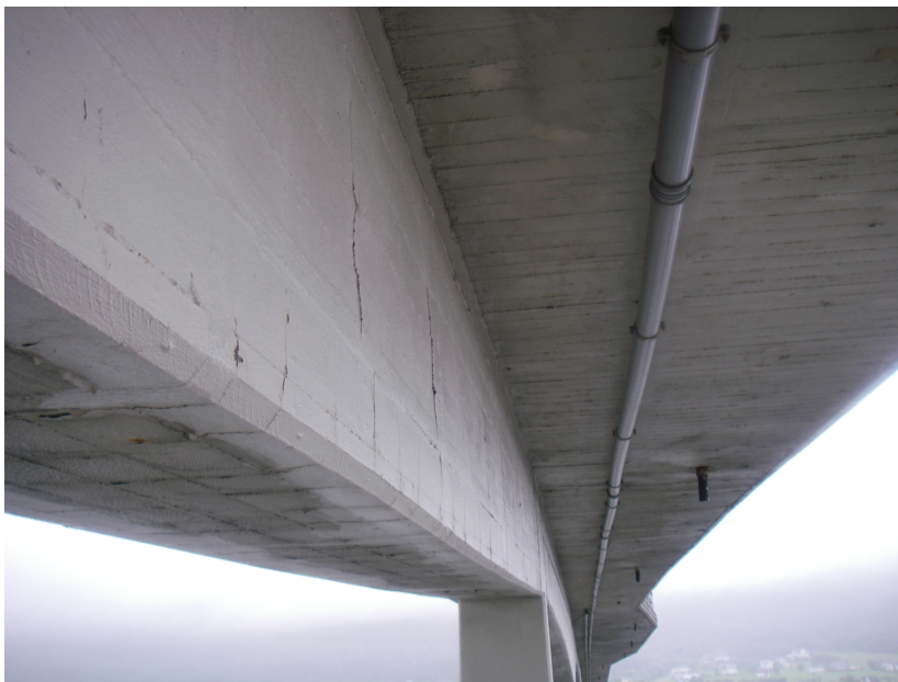
Figur 5.12: Tverrgående riss i akse 8-9
