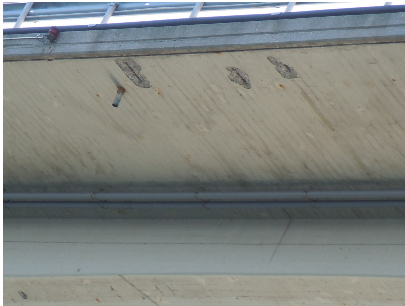
Figur 5.10: Delaminering og korroderende armering i underkant av plate i hovedfeltet
