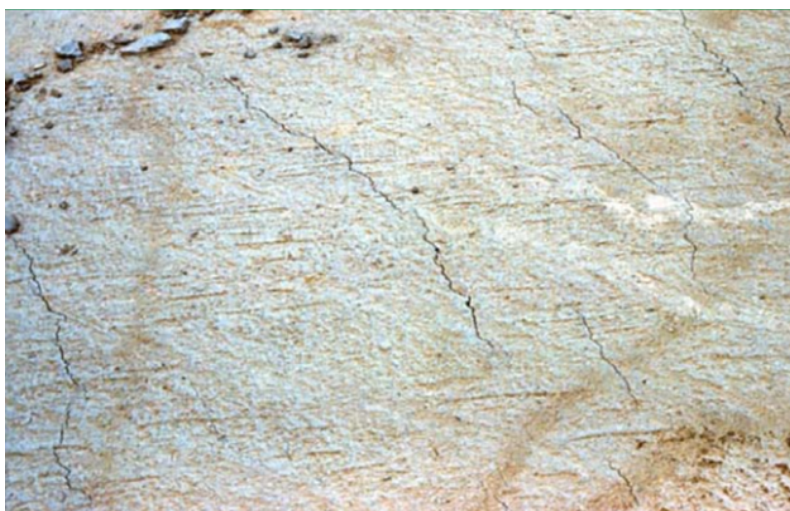
Figur 8.6: Eksempel på riss grunnet uttørkningssvinn [28]
