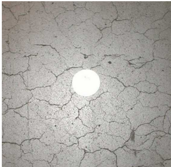
Figur 8.7: Eksempel på riss fra krakkelering [29]
