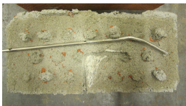
(b) Minimalt med skader på mørtelfugen
