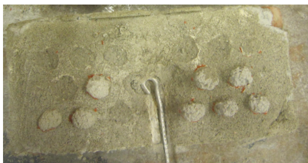
Figur 7.23: Lokal knusing av betong rundt binder
