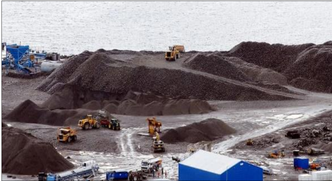
Figur 15: Gunnar Holth AS med grusutvinning, som senere blir tilgjengelig areal for Vestbase AS (bygg.no)
