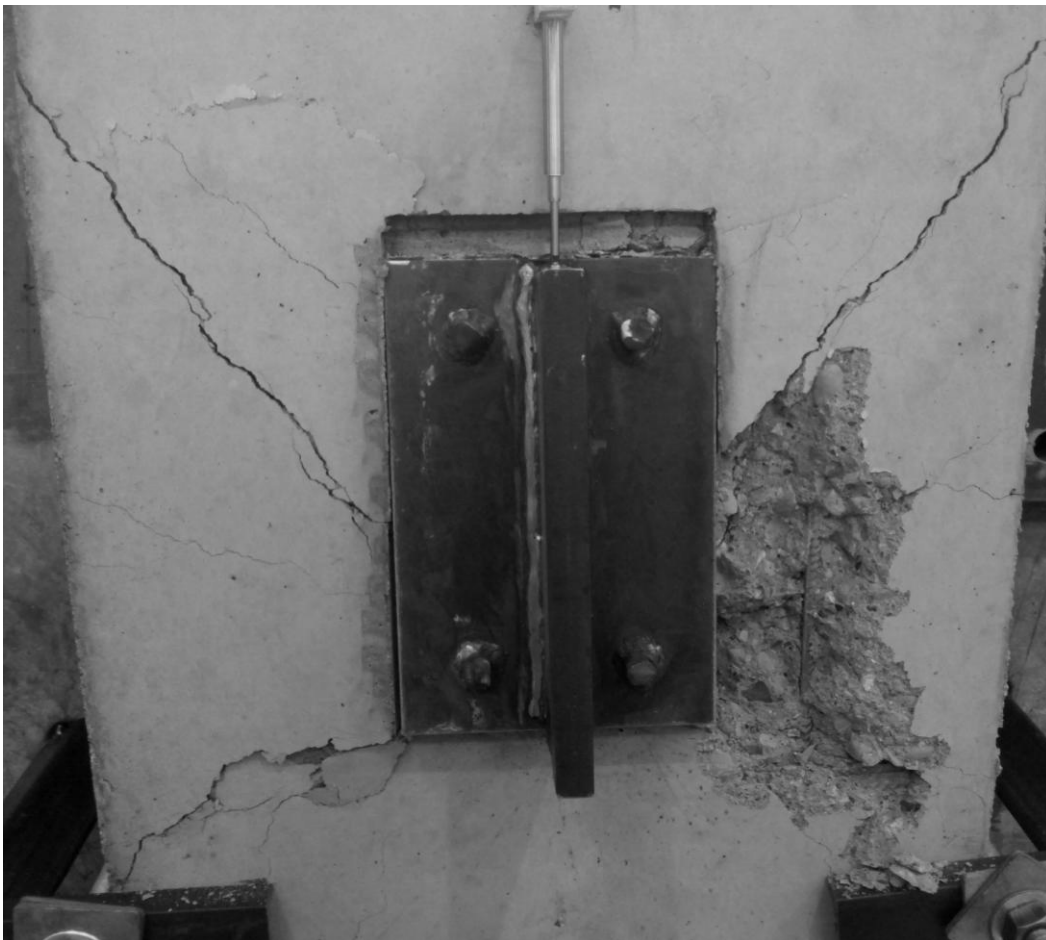
Figur 12.4: Bruddform på overflaten av betongprøvestykket A2.3.
