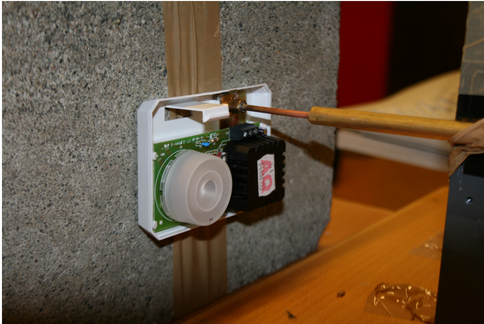
Figur 53: Måling: Røykvarsler på betong
