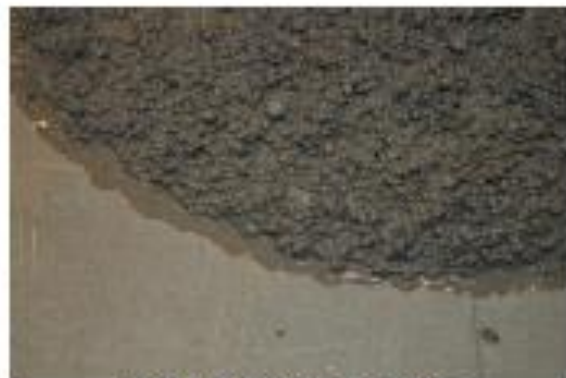
Figur 2: Separasjon i betongen Foto: Lisa Bakken
