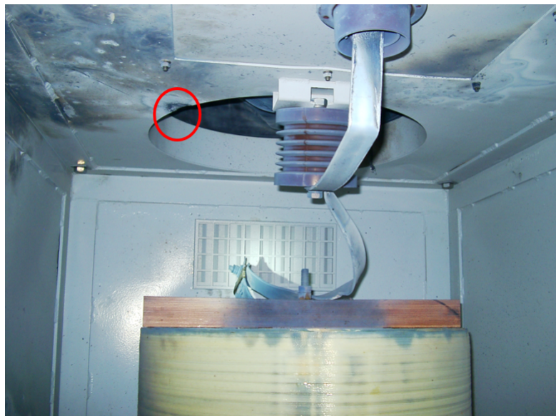
Figur E.2: Foto av tilkoblingsskinne til strømbegrensende spole etter kortslutning. Rød viser sted hvor det trolig har oppstått gjennomslag.
