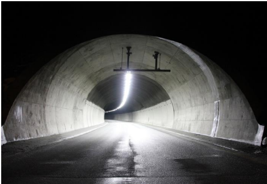
Figur 2.2: Første tunnel (Brekke) med LED som totalbelysning. I dag 79 armaturer med lysutbytte på 103 lm/W [2].
