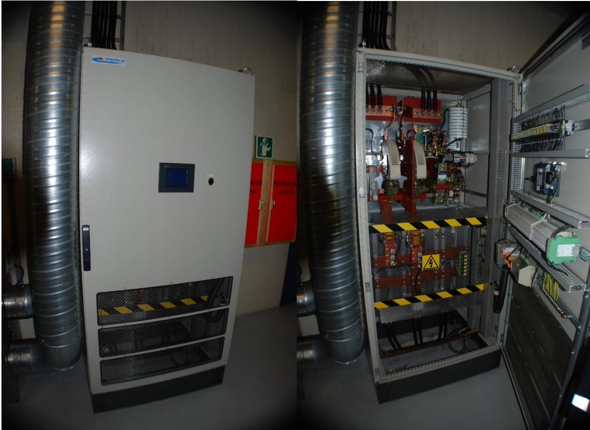
Figur 27: Spenningsregulatoren i Litjossen kraftverk.
