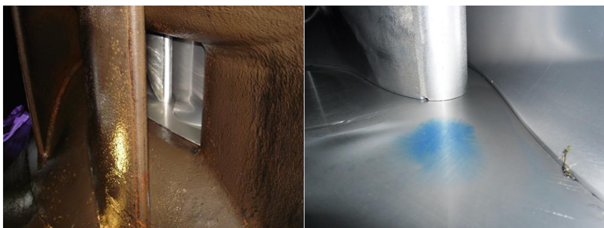
Figur 17: Staging og stagsøyler i bildet til venstre og ledeskovel med rivning i bildet til høyre.
