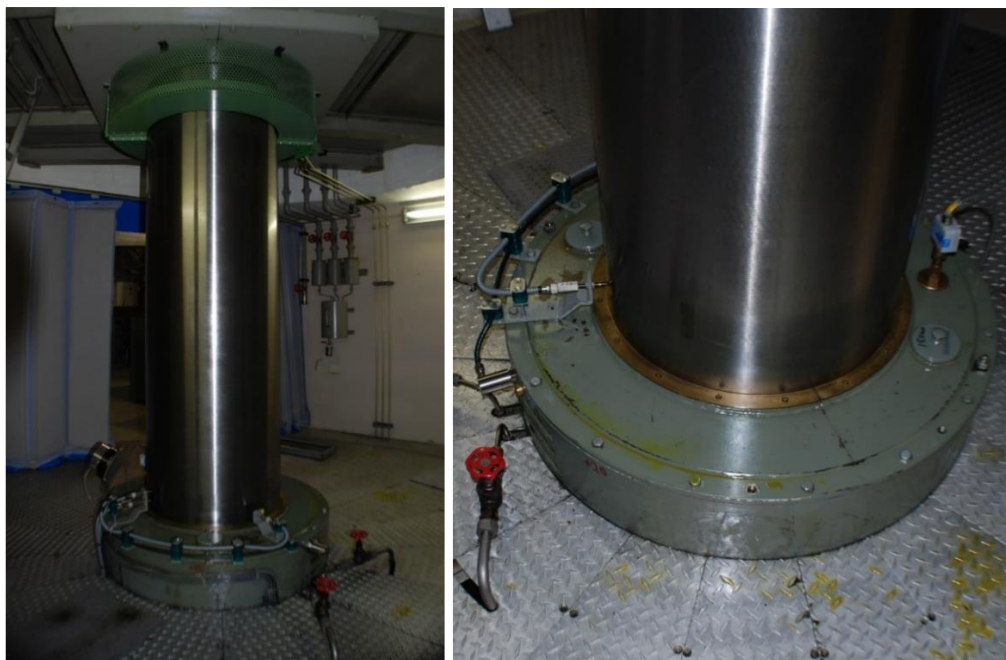
Figur 22: Viser akselstrengen mellom turbin og rotor med vibrasjonssensorer.
