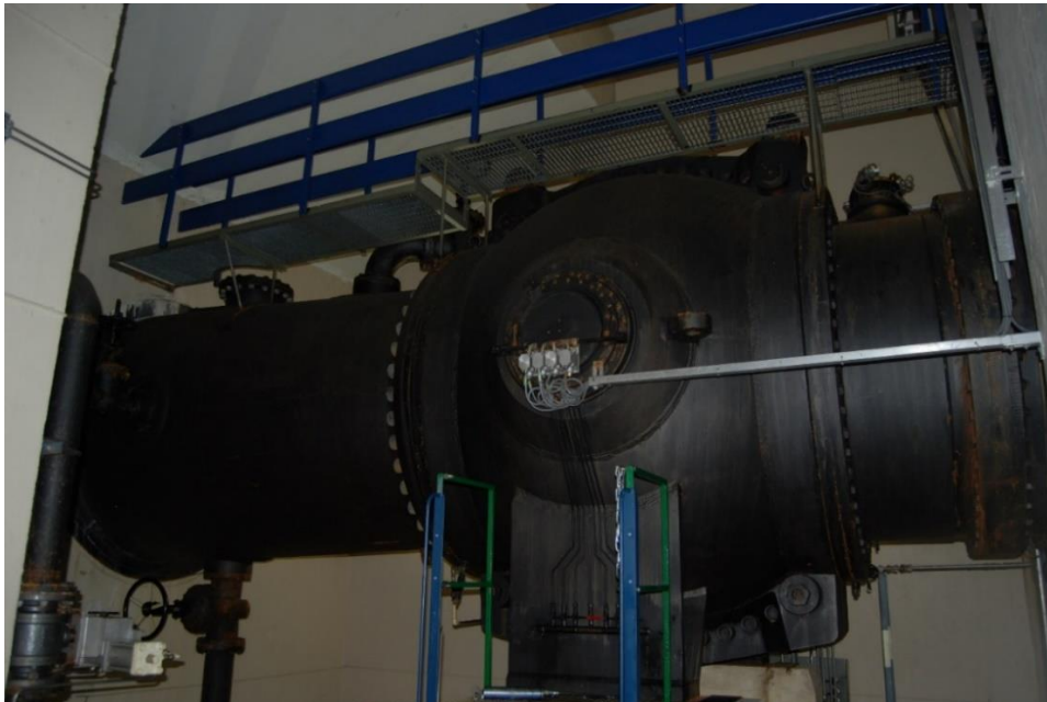
Figur 15: Kuleventil avbildet i turbinkjelleren.
