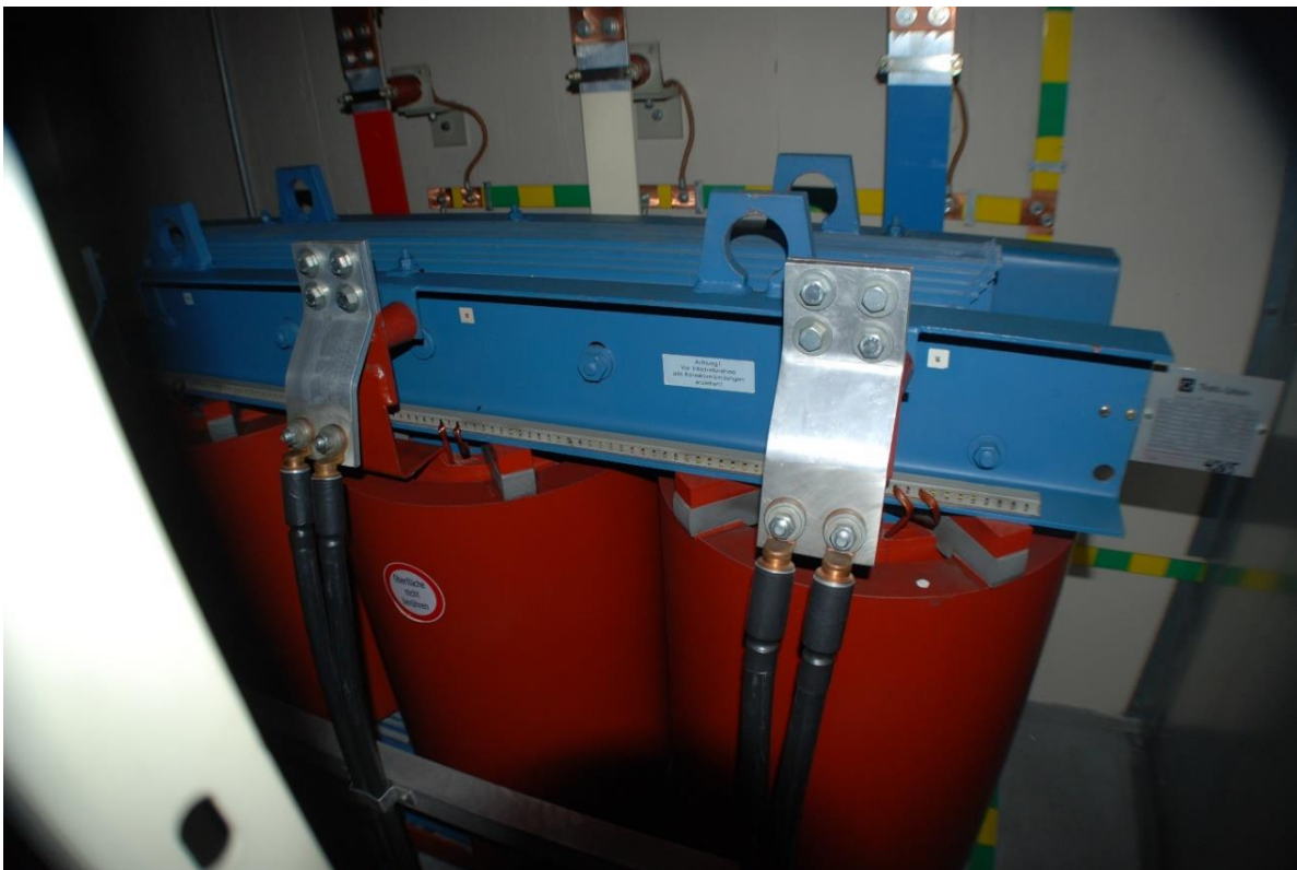
Figur 26: Magnetiseringstransformator for Litjfossen kraftverk.
