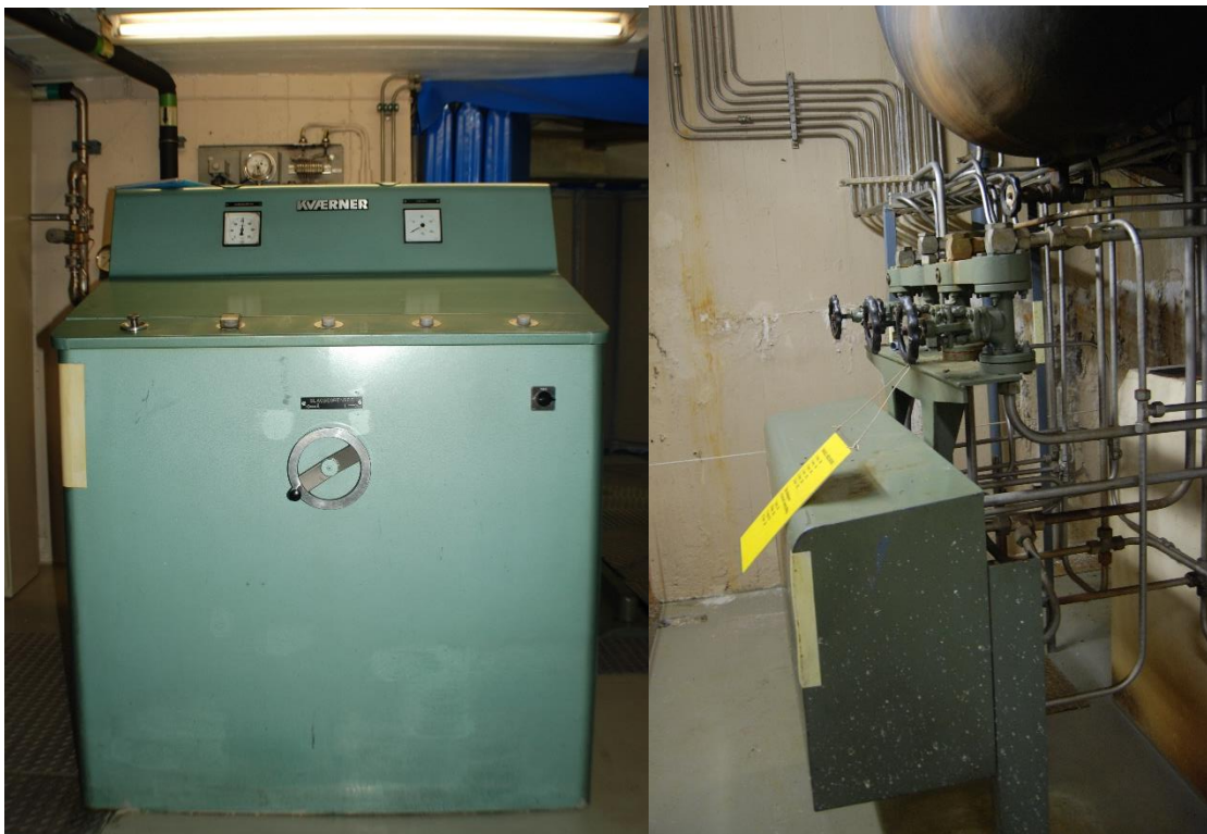
Figur 21: Ventilstyrepult til venstre og rørføring ventilstyring til høyre.
