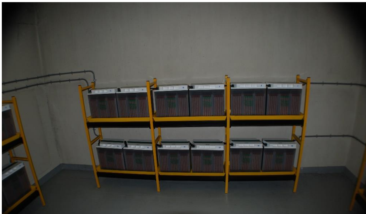
Figur 28: Viser 12 av de totalt 36 batteripakkene per rom.
