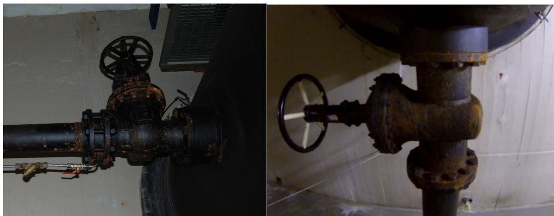
Figur 16: Ventil for injektor til venstre og tømmeventil trykksjakt til høyre.
