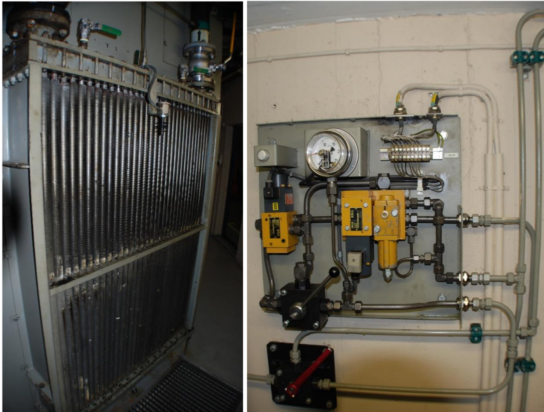
Figur 23: Generatorkjøler til venstre og bremsetavle generator til høyre.
