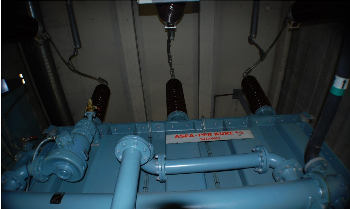
Figur 25: Krafttransformatoren til Litjossen kraftverk.
