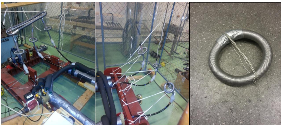
Figur 3.16: (V) Avlang koronaring ved aluminiumssamleskinne, (M) Koronaringer ved endeavslutningene, (H) Koronaring
