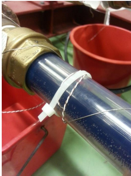
Figur 3.14: Sensor festet på ett vannrør med elektriker strips
