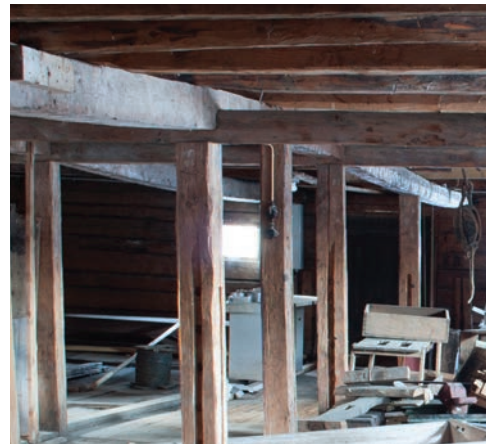
Nedbøyning drager 2. etasje. østre og vestre del
