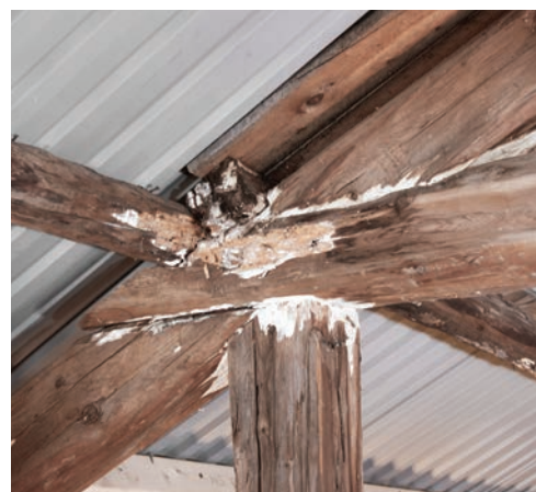
Sopp og råte i sperrebukk
