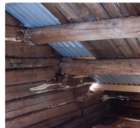
Sopp og litt råte i opplegg av åser
