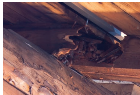
Råte i takås
