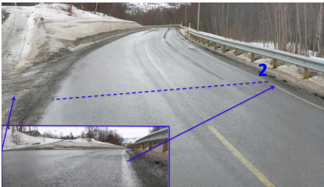
Figur 6.32: Mindre ujevnhet i vegbanen ved avslutning av skumglass-fylling (km. 2155).
