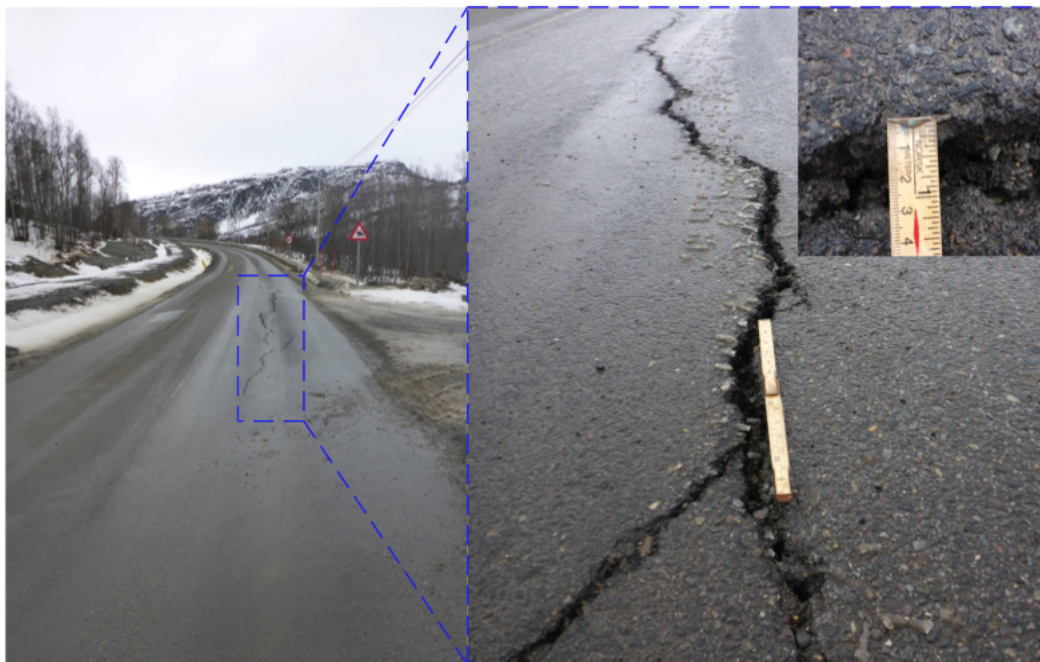
Figur 6.35: Oppsprekking av veg langs strekning 3. Sprekkene strekker seg fra km. 2810 -2820.
