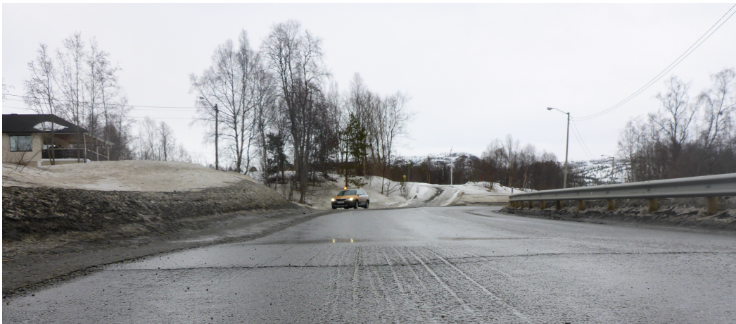
Figur 6.31: Telehiv sett fra motsatt side (i økende hp-retning).Sprekken i forkant er antatt å stamme fra det ujevne telehivet ved avslutning av skumglass-fylling.
