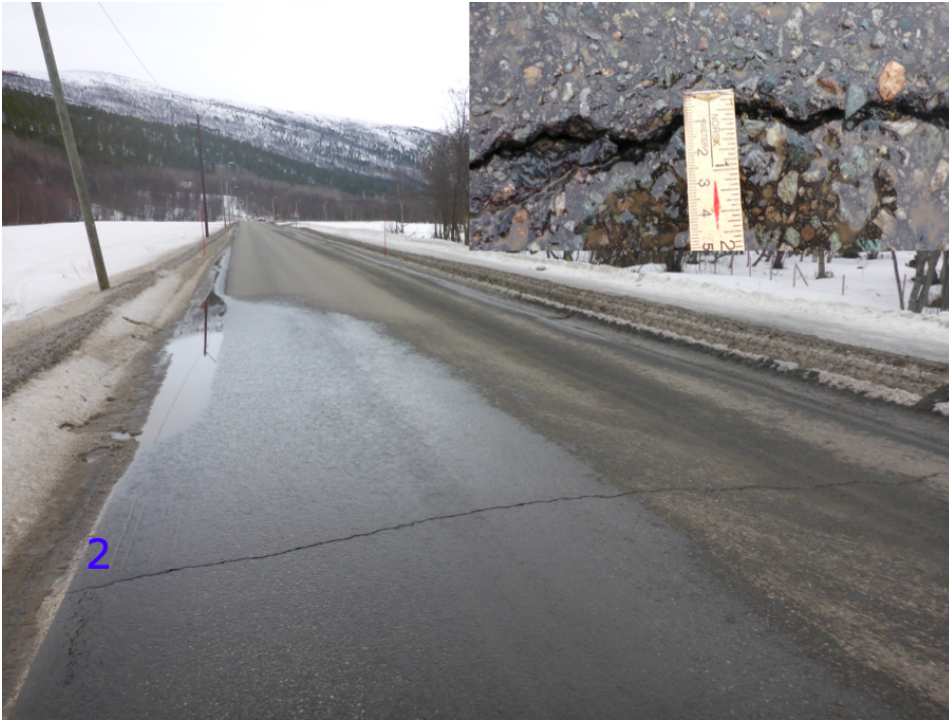
Figur 6.40: Telesprekk mellom to stikkrenner. Sprekken ligger ved km 4560.
