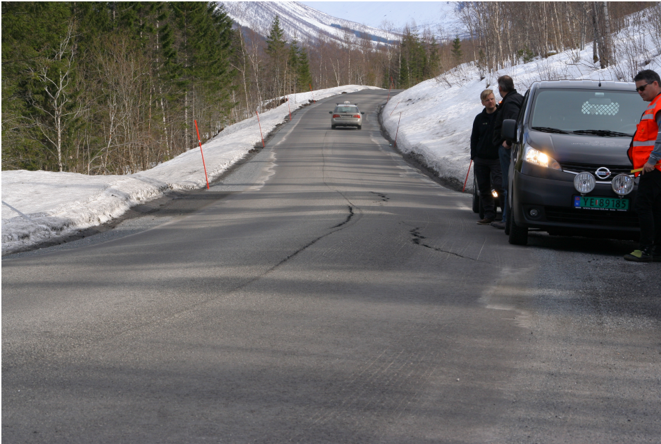
Figur 6.15: Langsgående sprekker dannet ved telehiv. Oppgraving av profil Meløy 1 er lokalisert der den nærmeste bilen befinner seg.
