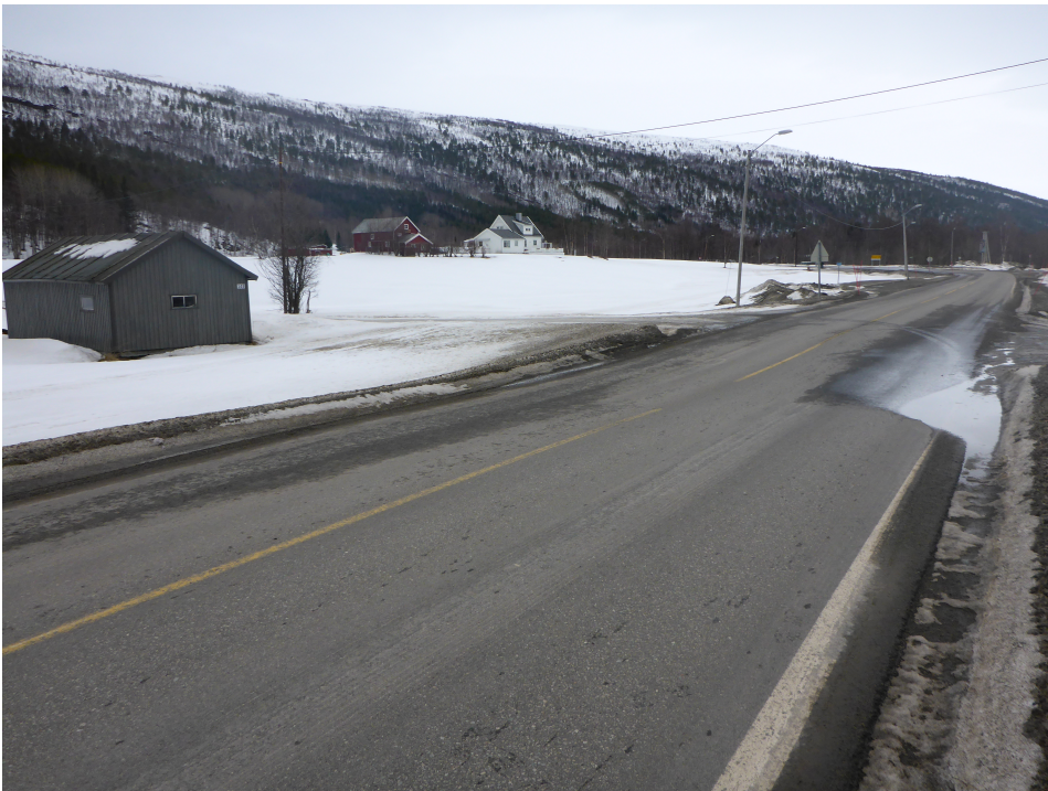
Figur 6.44: Oversiktsbilde for strekning 7. Sprekker finnes ved første avkjørsel, like etter vandammen.
