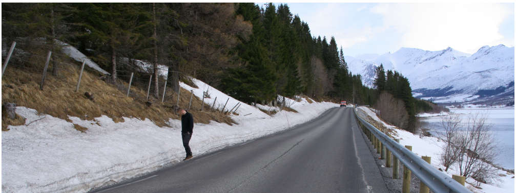
Figur 6.19: Oppgraving av profil Meløy 3 er lokalisert der mannen i bildet står. Like til venstre, på midten av vegen kan en se langsgående telesprekk.
