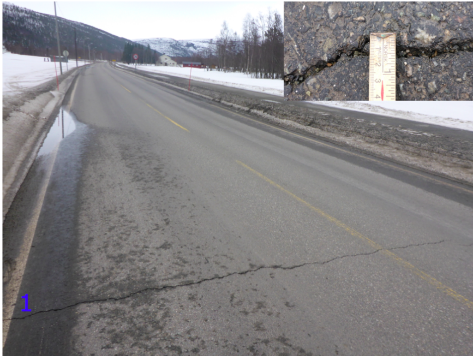
Figur 6.42: Telesprekk i front av stikkrenne. Sprekken ligger ved km 5315.
