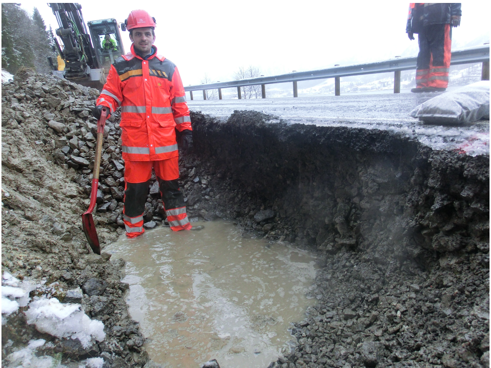
Figur 6.20: Oversiktsbilde av tverrsnitt for profil Meløy 4. Her var det tydelig vann i skille mellom undergrunn og pukklag.
