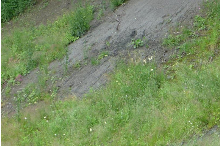
Figur 11.3: Moreneleire i skråningen ved utløsningsområdet (Foto: Terje H. Bargel)
