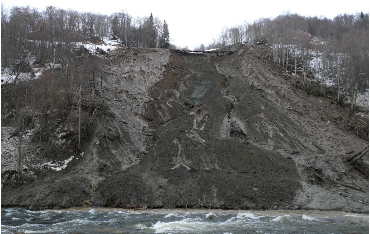
Figur 10.2: Skredet 14. mars 2012, hvor jernbanefyllingen skled ut på en 35 m lang strekning (Jernbaneverket, 2012).
