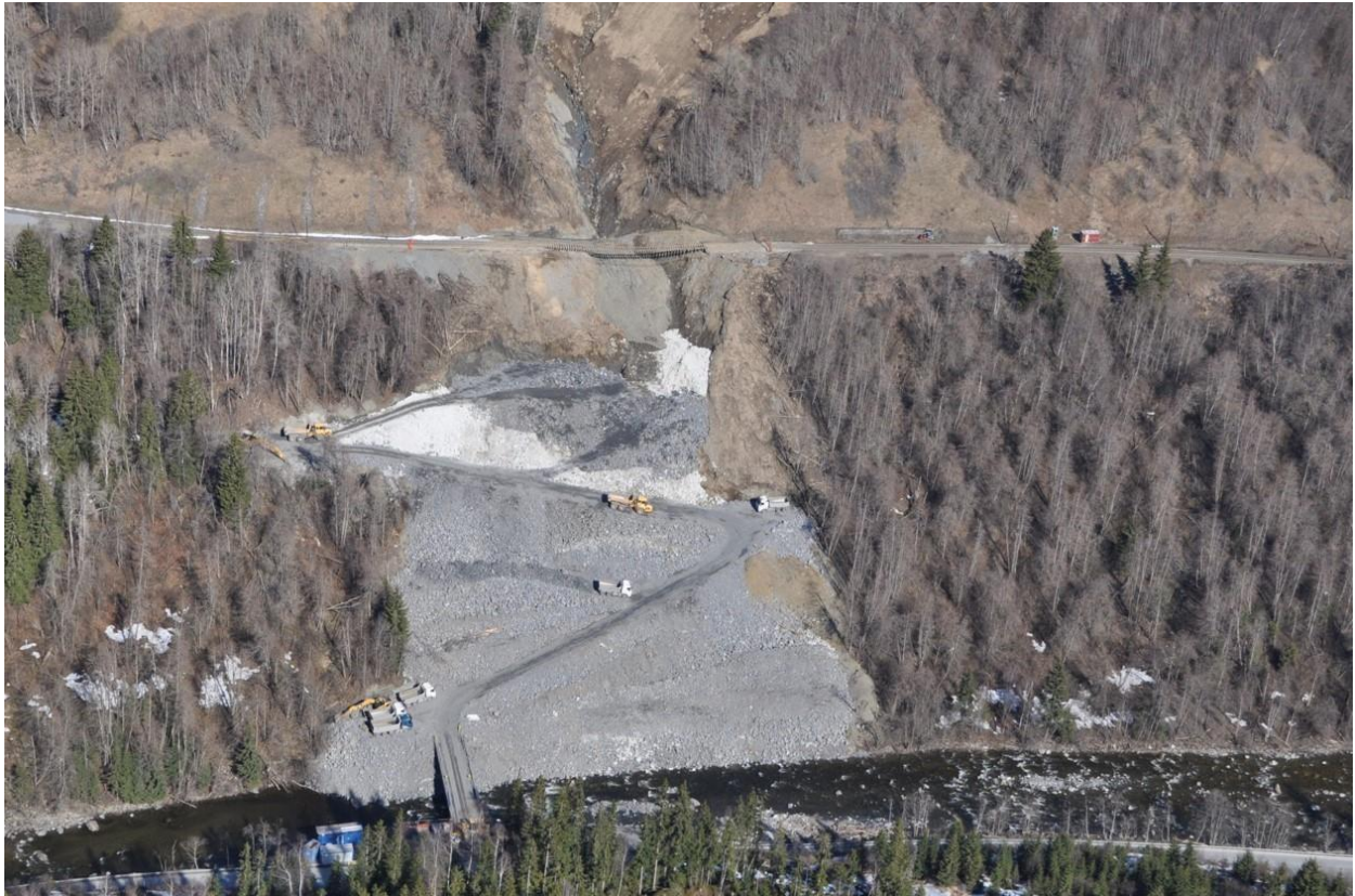
Figur 10.4: Gjenoppbygging av fylling. Anleggsveien ble etablert nedenfra og oppover mot jernbanesporet (Jernbaneverket, 2012).
