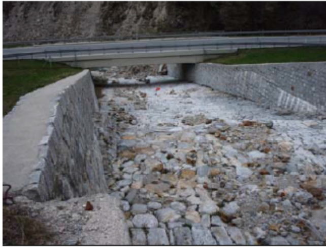
Figur 4.12: Bro og ledevoller som fører inn mot brua knyttet til elveløp i Ponte Rossa, Biasca, Sveits (Norem and Sandersen, 2011).
