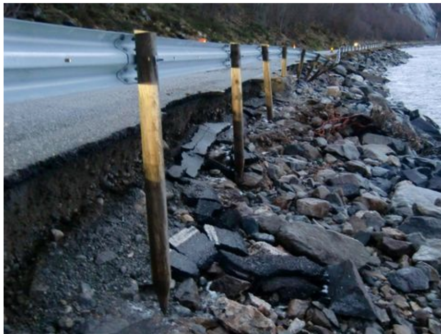
Figur 5.9: Utvasking av veien ved fv.660 langs Eresfjorden etter Dagmar uværet (Loe Welde and Brunvoll, 2012)
