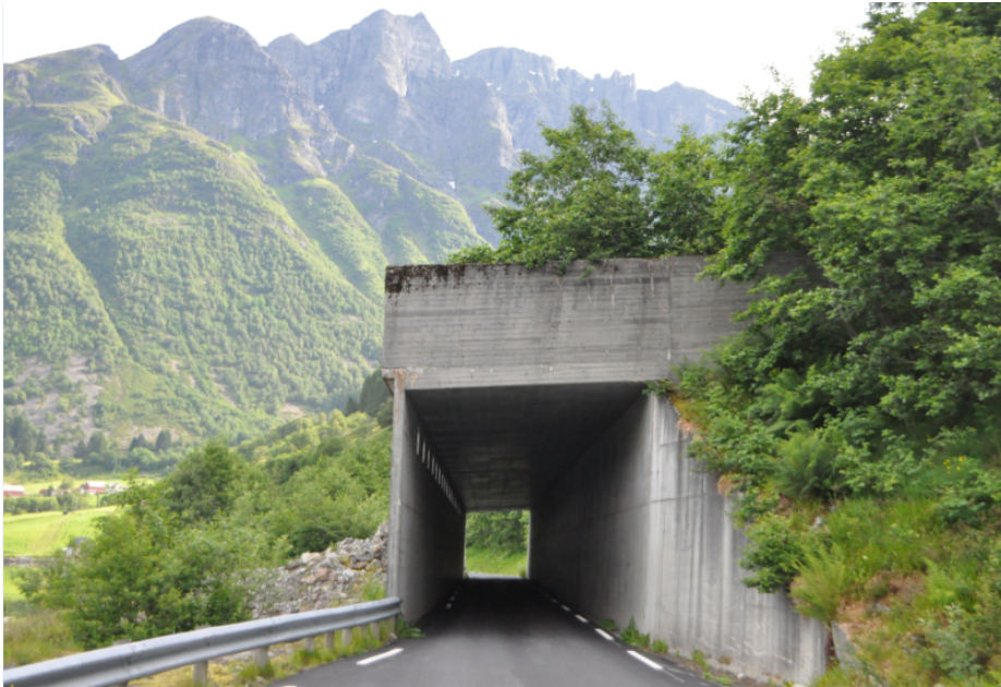
Figur 3.19: Skredoverbygg ved fv.41 Løggjølet i Møre og Romsdal (Foto: Kari Linn Søreide)
