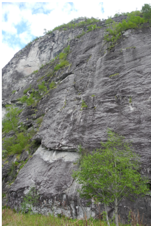
Figur 6.6: Eksfoliasjonsoppsprekking ved fjellveggen hvor profil 1 er satt (Foto: Kari Linn Søreide)
