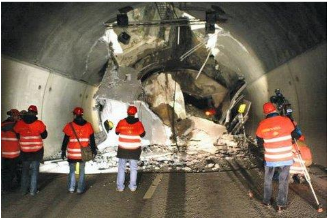
Figur 9: Bilde av raset i Hanekleivatunnelen fra 25. Desember 2006. Foto: Bjørn Fredriksen, Jarlsberg
