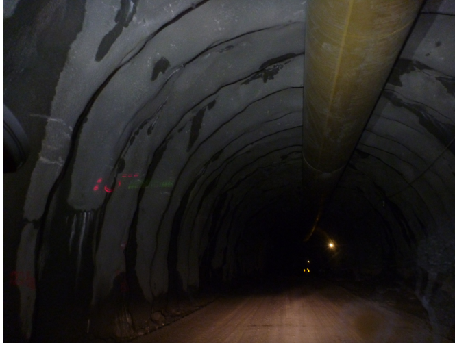
Figur 5.21 – Sprøytebetongbuer satt opp i løp 12 i forbindelse med forkastningssonen ved profil 8300-8330. Foto: Mari Lie Arntsen.
