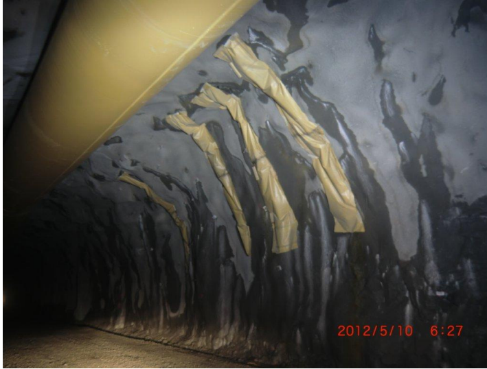
Figur 5.19 – L12, ca profil 8050: Dukløsning for å lede lekkasjevann ned i grøfta gjennom sone med høy vannføring. Foto: Lars Langhelle.
