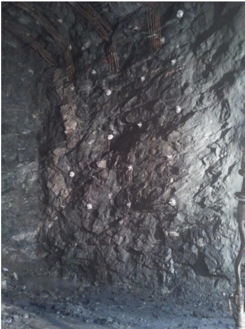
Figur 5-5. Tunnelvegg mot vest. Her ser vi tydelig lagdelingen til bergmassen med strøk på omlag 70 ° i forhold til driveretningen, og slakt fall innover (mot sørøst). Foto: Asta Krattbøl
