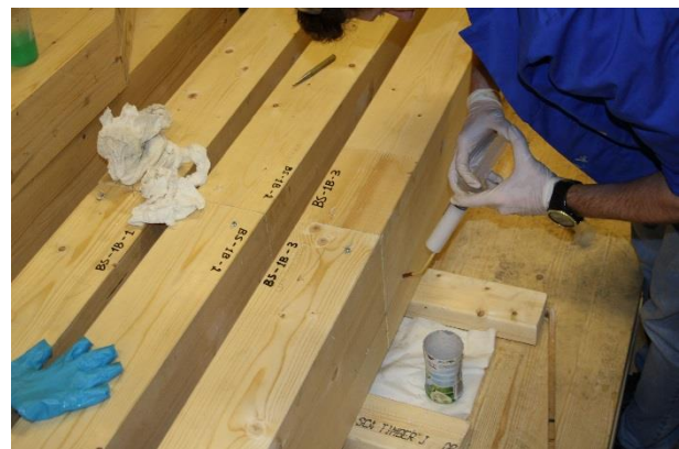
Figur VI-26: Gysing av lim i bjelkeskjøten. Limet ble gyst fra den ene siden, gjennom hylsen og ut gjennom gysehullet i den andre bjelken.
