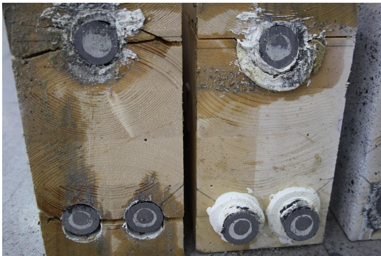
Figur 5-20: Bildet viser at hylsene er fulle av lim. Dette var også tilfellet for alle andre hylsene bortsett fra en.
