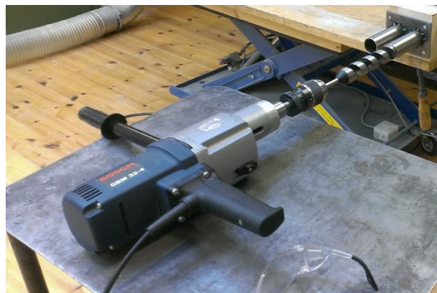
Figur V1-15: Boret først med et 38mm trebor for å lage hullet som stålhylsen skal passe inn i.
