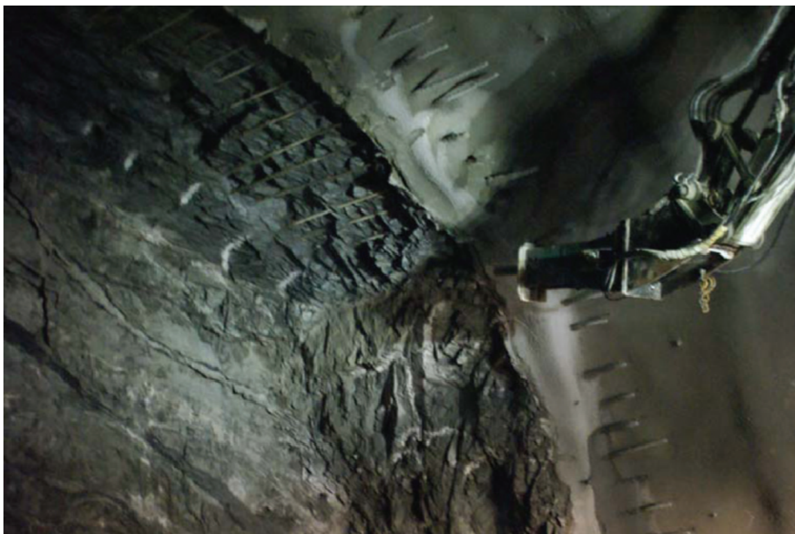
Figur 3-4: Situasjonen på stoff ved profil 2858 i den antatte metasandsteinssonen som gikk fra profil 2800 frem til ca. profil 2945. Her har det blitt passert svært dårlig skiferfjell med utfall opp mot spilingboltene (Statens vegvesen, 2011h).
