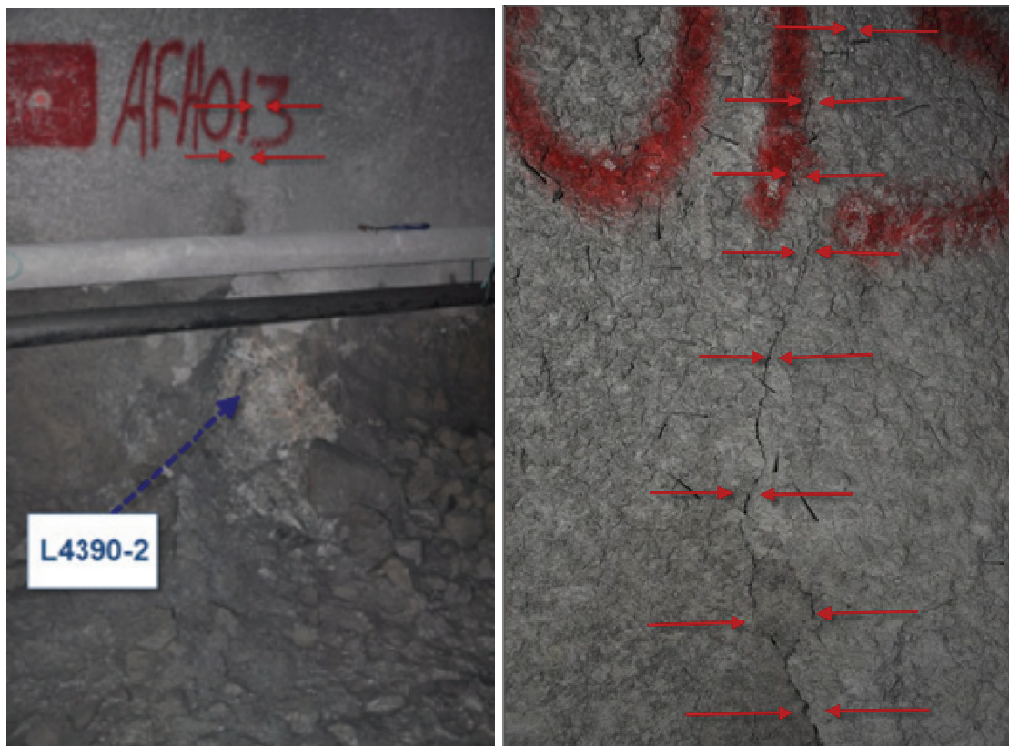
Figur 4-29: Prøve L4390-2 er hentet fra en tydelig leirsone ved profilnummer 4390 (venstre). I sprøytebetongen over sonen (venstre bilde) er det tydelige sprekker i sprøytebetongen. Nærbilde av sprekken på bildet til høyre.
