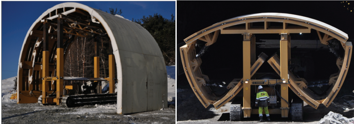
Figur 6-1: Oppmontert støpeskjold (venstre), med beltedrift for transport inn i tunnelen (høyre) (Moen, 2011b).
