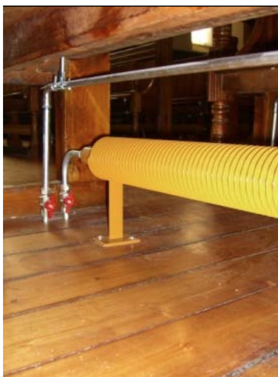
FIGUR 9.3: Oppvarmingsløsning med vann som energibærer i Lærdal Kirke. (lærdal.kommune.no)
