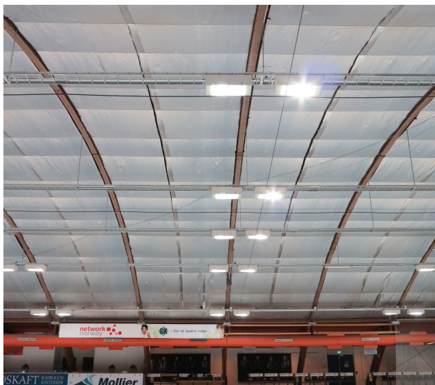
FIGUR 4.12: Reflekerende duk i taket
