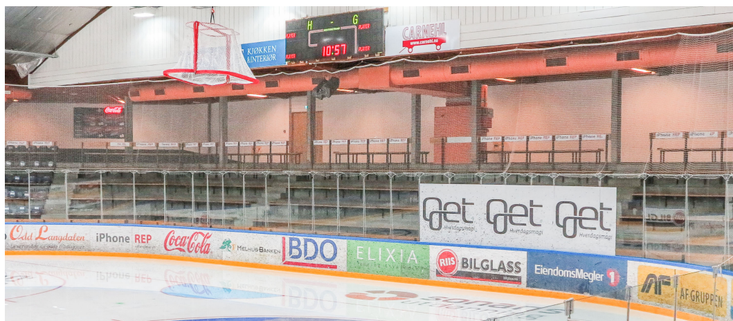
FIGUR 4.16: Den store oransje boksen midt i bildet inneholder selve avfukteren, som fordeler luften gjennom ventilene i det oransje røret i toppen av bildet. Foto: Daniel Bergsagel
