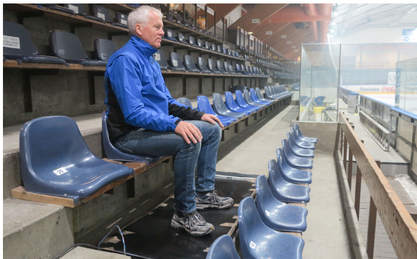
FIGUR 8.10: Bilde som illustrerer hvordan oppvarmingen prinsipielt er tiltenkt. Det svarte panelet på gulvet er oppvarmet.
