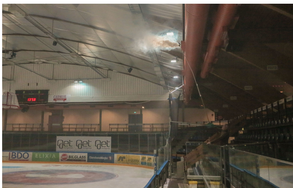
FIGUR 8.4: Røyk tilsatt til utblåset som går vannrett ut mot banen. Igjen ser vi at luften stiger opp og legger seg under taket over banen. Verken publikum eller utøvere får nytte av dette.
