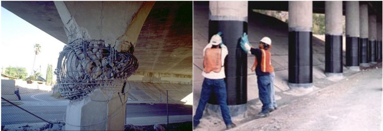
Bilde 9: Skjærbrudd i søyle (venstre) og pålegging av CFRP-forsterkning på søyler (høyre). Hentet 12.februar 2015 fra: http://www.umich.edu/~acemrl/NewFiles/projects/recc.html og http://www.luckett-farley.com/frp-strengthening/
