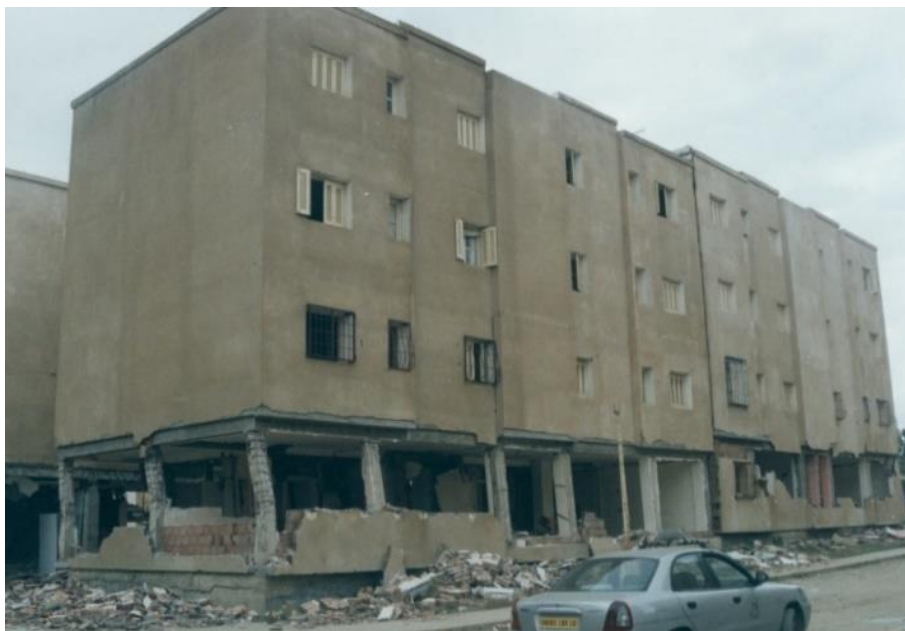
Bilde 12: Ødeleggelse etter jordskjelv i Algerie i 2003.
