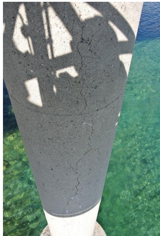
Figur 20 Riss pilar akse 4 mot sør
