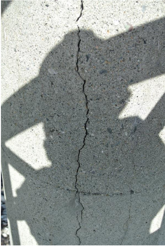
Figur 15 Riss søndre pilar akse 3 mot sør
