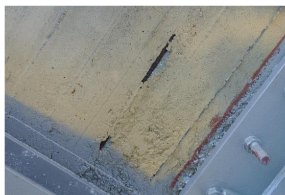
Figur 5 Frilagt armering undersiden dekke, ved akse 24
