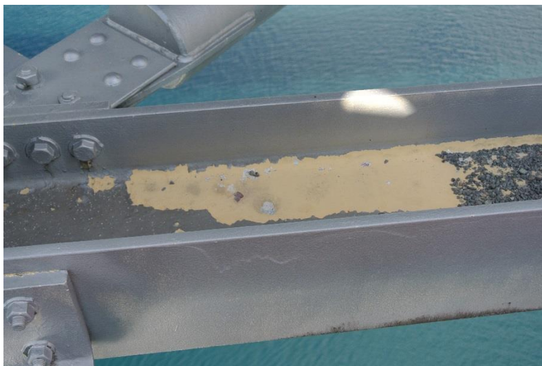
4.14 Malingavskalling på undergurt i hovedspenn
