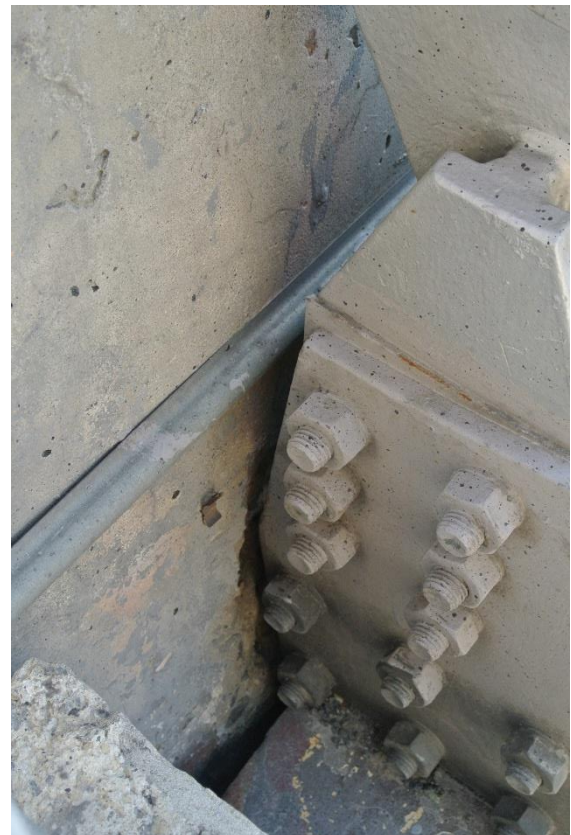
Figur 14 Undergurt har skadet betong, dette er ved akse 24 søndre tårnsøyle mot vest. Men er gjort tiltak i fagverket ved
