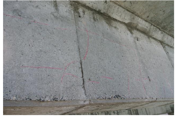
Figur 18 Riss i dekke mot sør mellom akse 3 og 4 (samme som figur 17)
