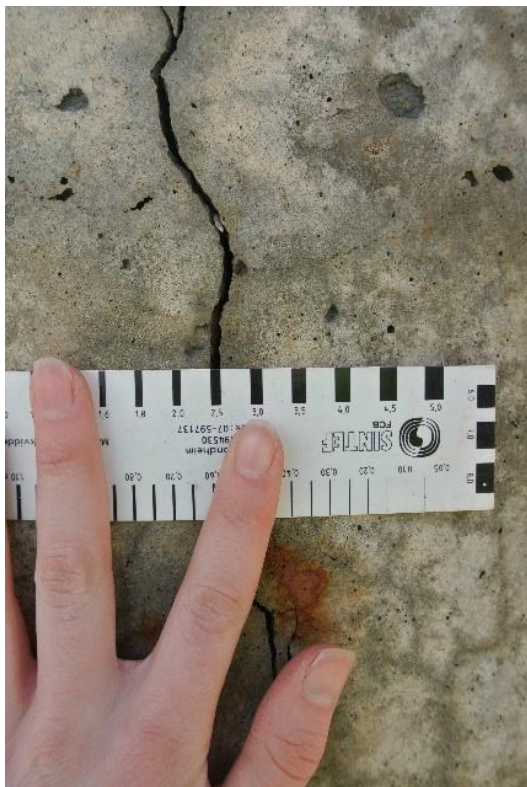
Figur 26 Riss og krakelering akse 3
