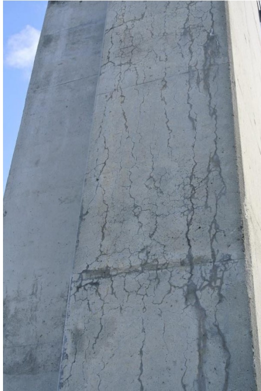
4.8 Krakelering i tårn akse 24 (V) mot vest
