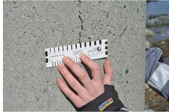
Figur 27 Riss i nedre akse 3 søndre søyle mot sør
