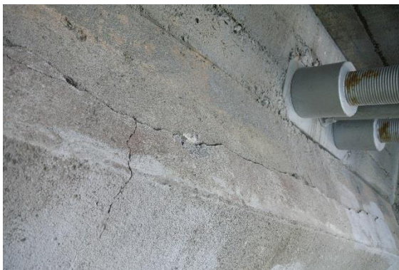
Figur 37 Riss i kabelforankring i øst
