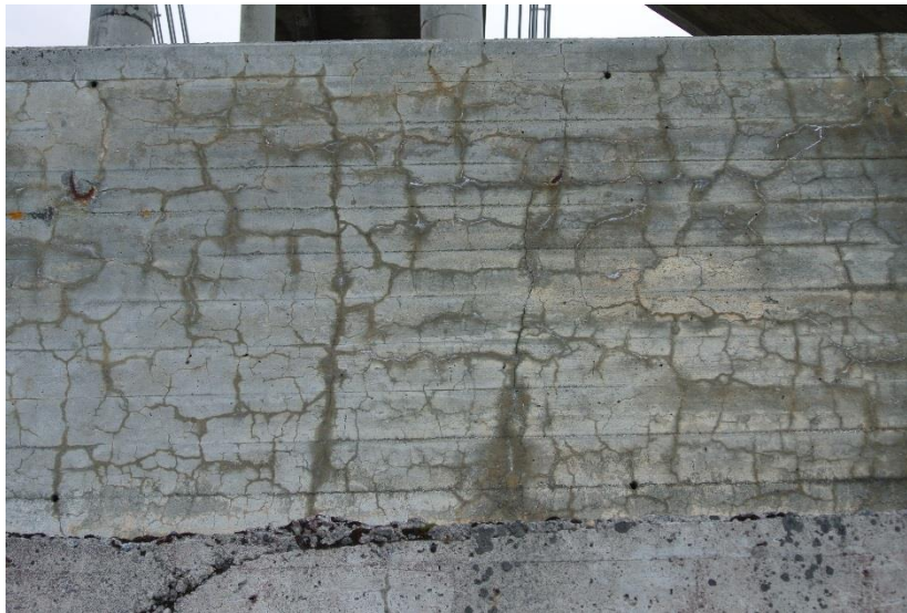
4.9 Krakelering akse 25, i fundament søyler og betongkryss
