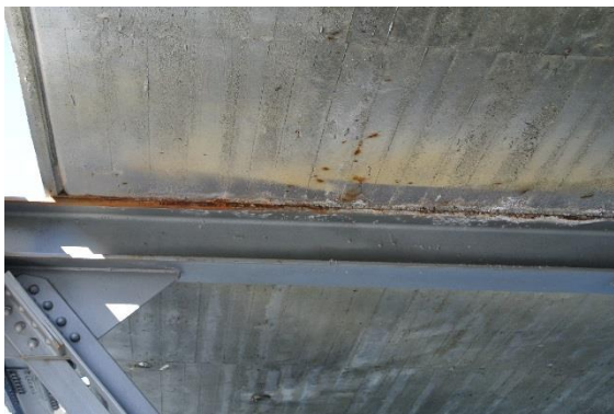
Figur 7 Rust ved overgang til betong, undersiden dekke ved akse 24
