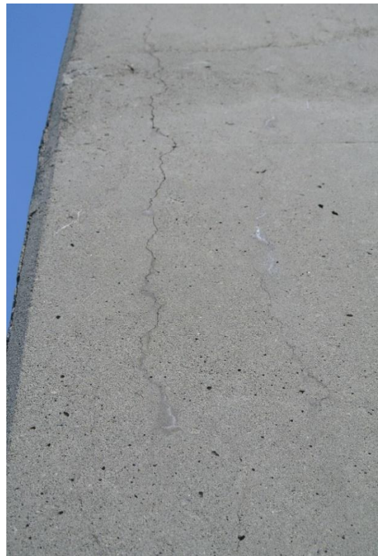
Figur 10 Riss, nordre tårnsøyle akse 24, mot sør
