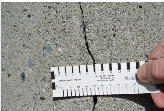
Figur 16 Riss søndre pilar akse 3 mot sør
