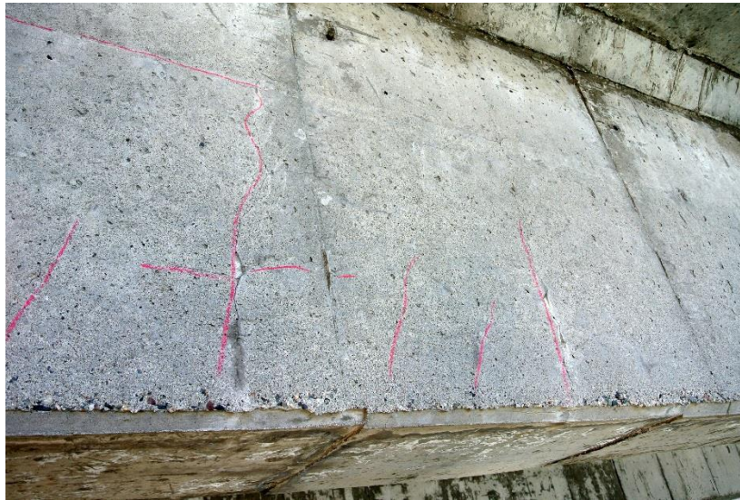
4.7 Vertikale riss i dekket mellom akse 3 og 4
