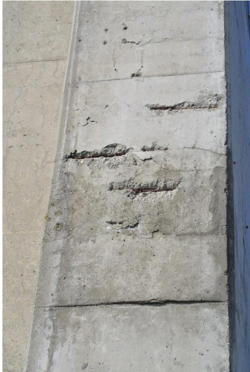
Figur 11 Betongavskalling og armeringskorrosjon, akse 24 søndre tårnsøyle, mot øst
