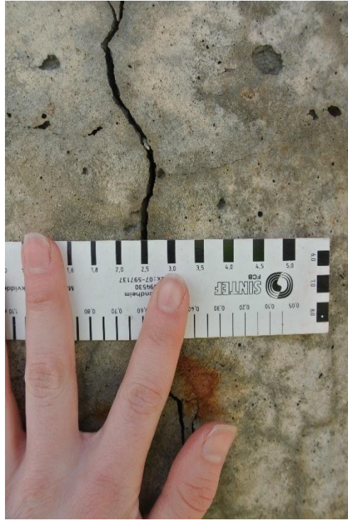
4.5 Riss i pilar
