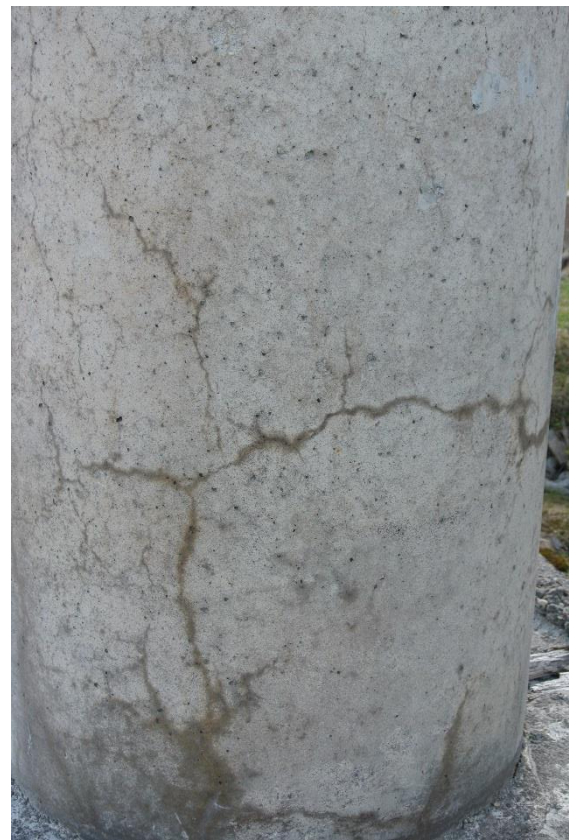
Figur 24 Krakelering nordre pilar nede på akse 2 mot nord
