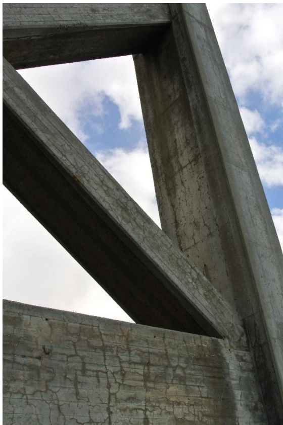
Figur 36 Krakelering i vindkryss akse 25
