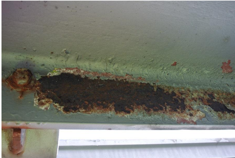
4.15 Korrosjon på undergurt i hovedspenn
