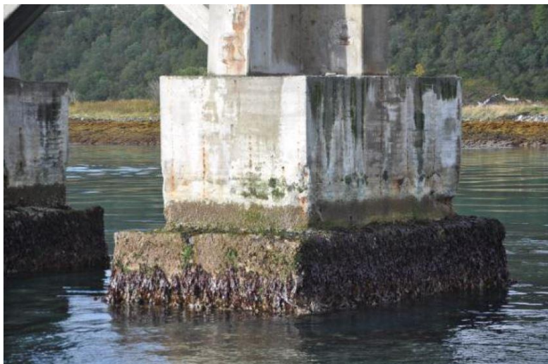
4.11 Skader på fundament [4]
