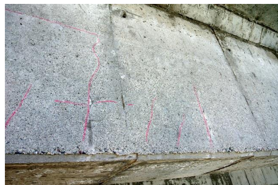
Figur 29 Vertikale riss i dekke midt mellom akse 3 og 4.
