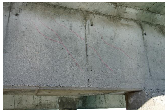
Figur 19 Riss i dekke mot sør, ved pilar akse 4
