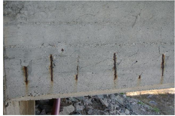
Figur 23 Betongavskalling og korrosjon i dekke, ved akse 1 mot sør
