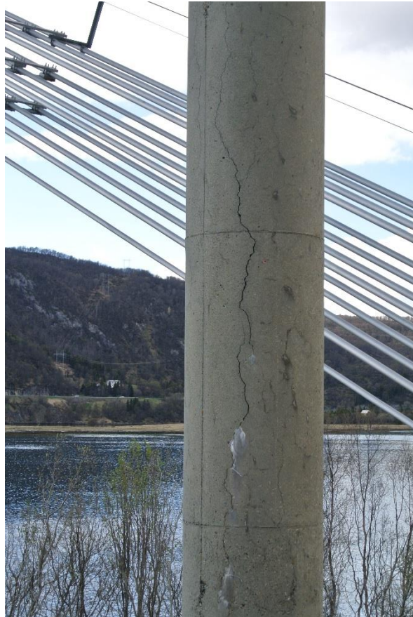
4.4 riss i pilar
