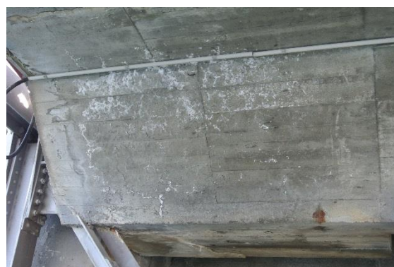
Figur 4 Utfellig, undersiden dekke ved akse 24
