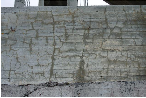
Figur 35 Krakelering fundament akse 25 mot vest
