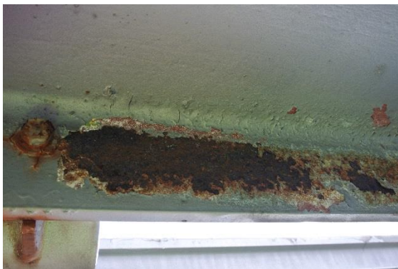
Figur 31 Rust i innside av søndre overgurt i hovedspennet
