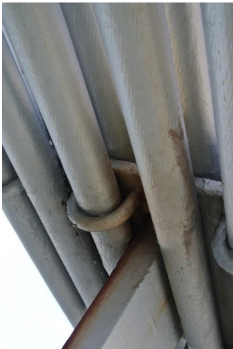
Figur 32 Korrosjon på hovedkabel ved hengestangfeste
