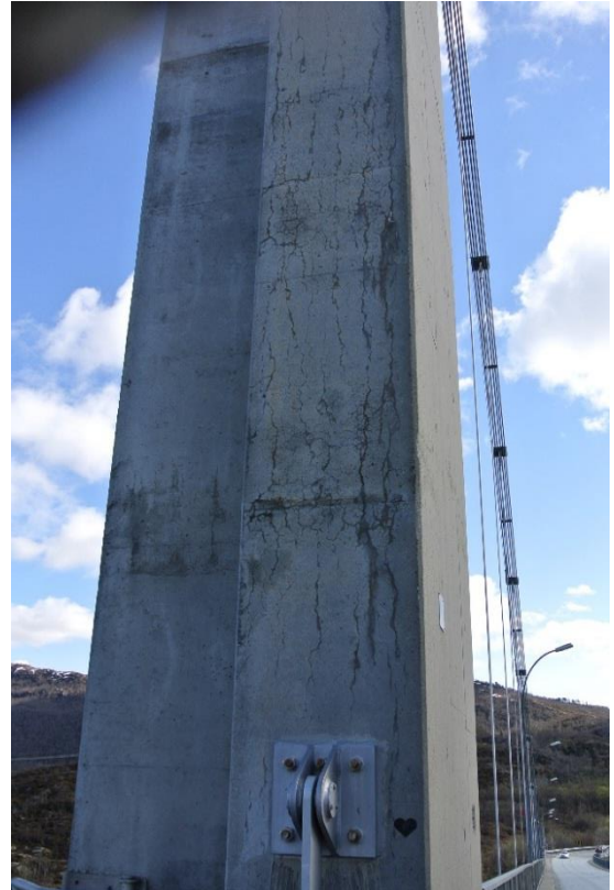
Figur 9 Krakelering nordre tårnsøyle akse 24. Krakelering mot vest
