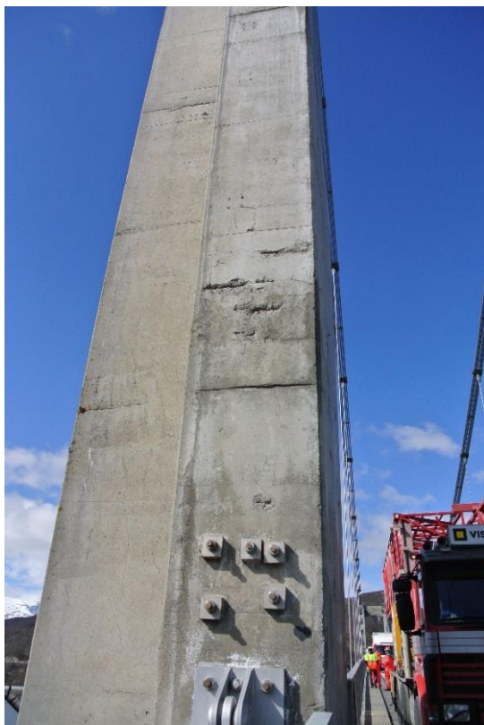
Figur 12 Betongavskalling og armeringskorrosjon, akse 24 søndre tårnsøyle, mot øst (samme som figur 10)
