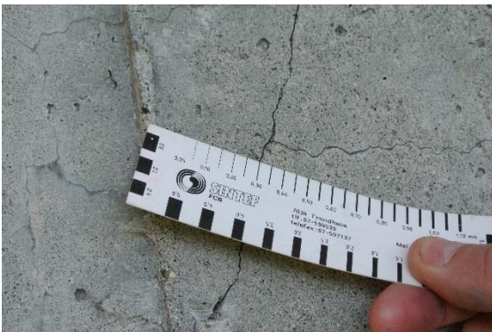
Figur 17 Riss i dekke mot sør mellom akse 3 og 4
