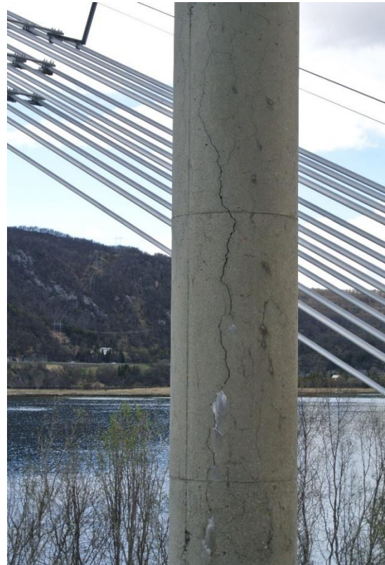
Figur 38 Riss akse 26 nordre pilar mot sør
