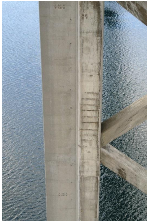
4.3 Frilagt armering ca 10 meter nedenfor kjørebane
