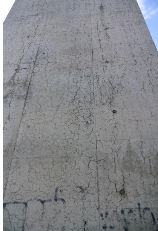
Figur 13 Krakelering søndre tårnsøyle, akse 24 mot nord
