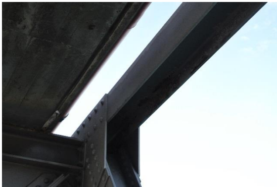
Figur 8 Maligavskalling og rust i overgurt ved akse 24
