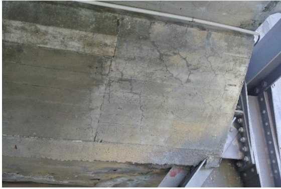
Figur 6 Krakeleringer undersiden dekke ved akse 24
