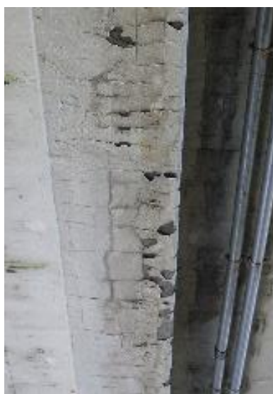
Figur 91: Nærbilde av tverrgående og langsgående riss i feltmidte mellom Akse 1 og 2
