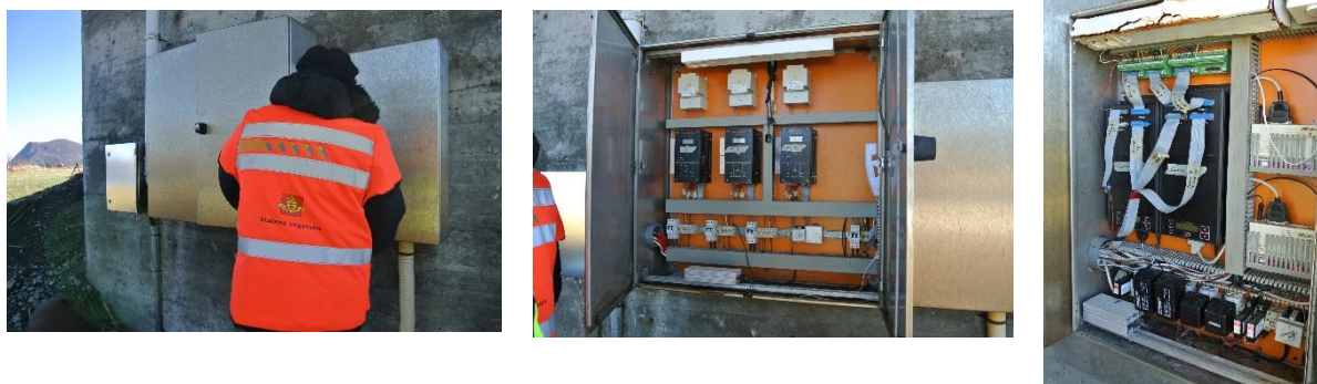
Figur 127: Styreskap for katodisk anlegg ved Akse 1
