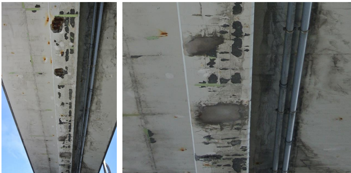
Figur 93: Skader på underside bruoverbygning i Felt 2
