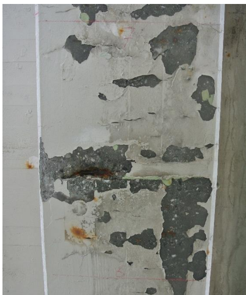
Figur 119: Bom med rustutslag og korroderende armering mellom 6 og 7 m-markøren
