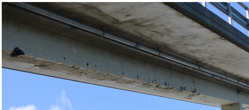
Figur 94: Riss på siden av brubjelke i Felt 2
