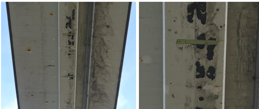
Figur 96: Rustutslag og avflakende beleg, samt ubeskyttet anodebånd i Felt 4
