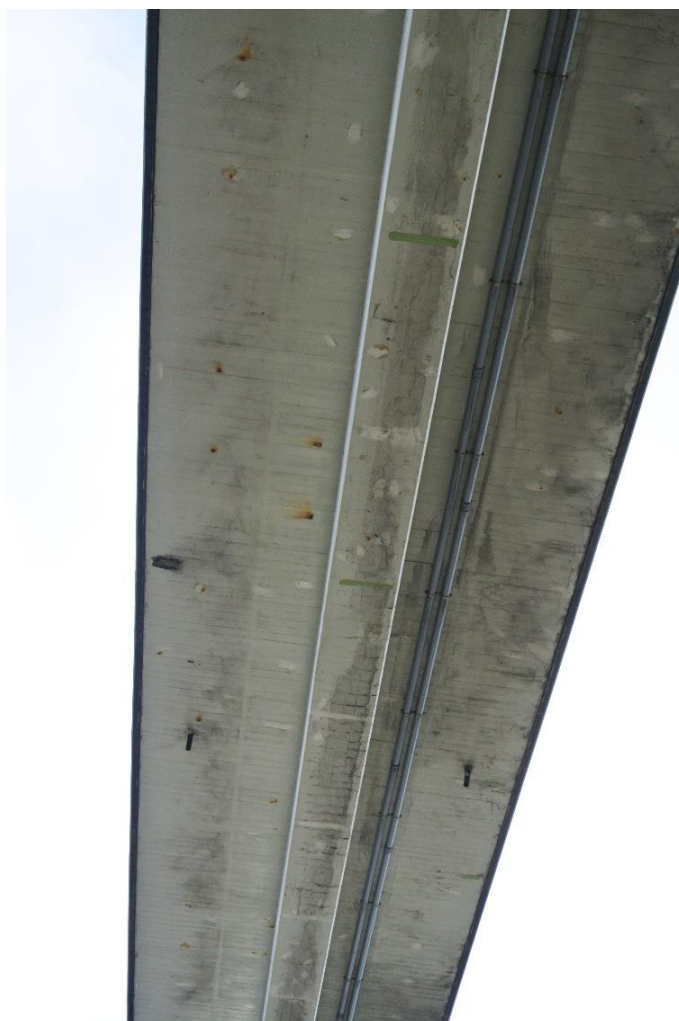
Figur 97: Tydelig tverriss i feltmidte mellom Akse 5 og 6
