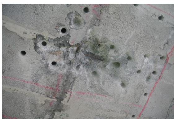
Figur 125: Lite tegn til armeringskorrosjon ved 9 m
