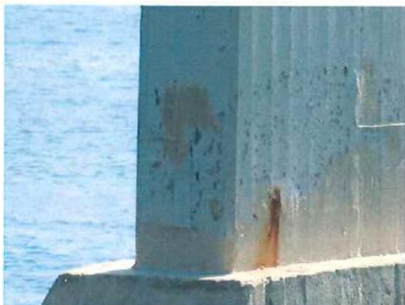
Figur 84: Slitt og avflakende overflatebehandling og rustutslag på søyle i Akse 13 [12]
