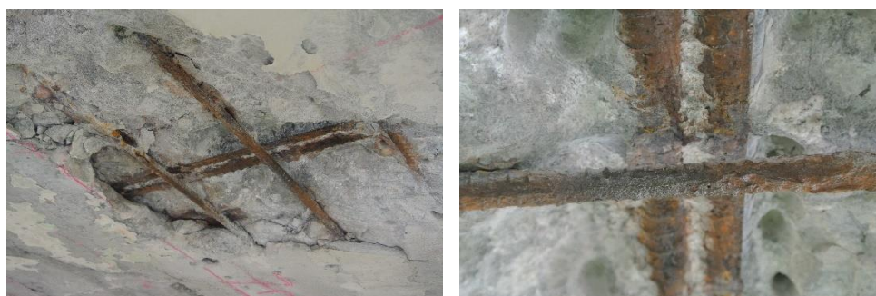
Figur 123: Rustende armering ved 7 m-markøren
