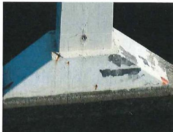
Figur 85: Avflakende overflatebehandling på fundament i Akse 10 [12]
