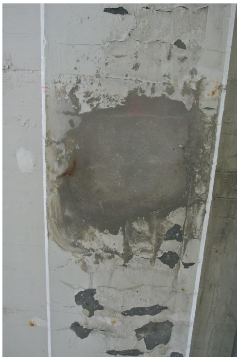
Figur 120: Reparert bomskade mellom 7 og 8 m-markøren
