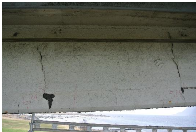
Figur 114: 5 til 6 m på nordsiden av bjelken mellom Akse 2 og 3
