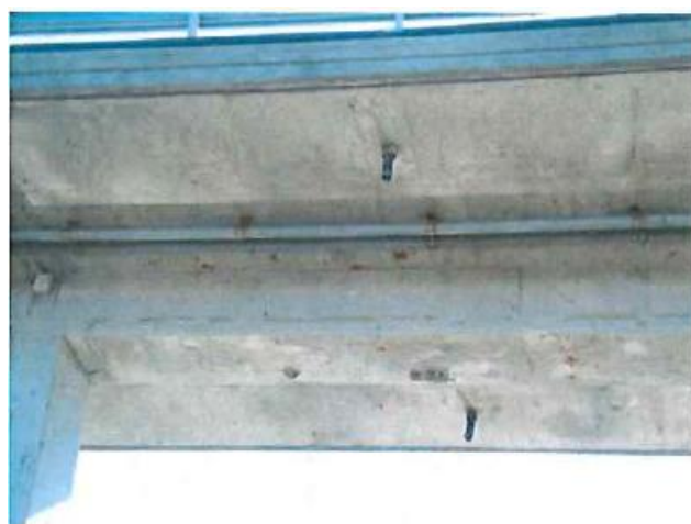
Figur 80: Punktskader i underkant av brubjelke felt mellom Akse 17 og 18 [12]
