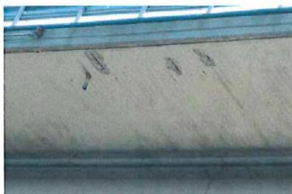
Figur 82: Avskalling og frilagt armering i underkant bruplate feltmidte mellom Akse 10 og 11 [12]
