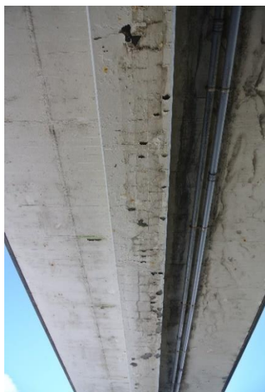
Figur 90: Rissdannelse og avflakende belegg, bruoverbygning mellom Akse 1 og 2
