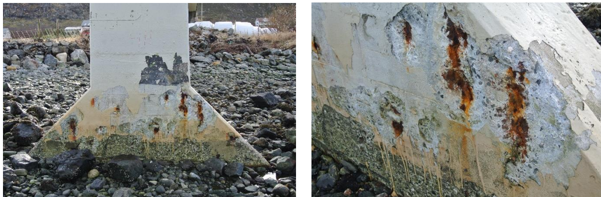
Figur 100: Høyresiden av fundamentet i Akse 4 er sterkt preget av skader
