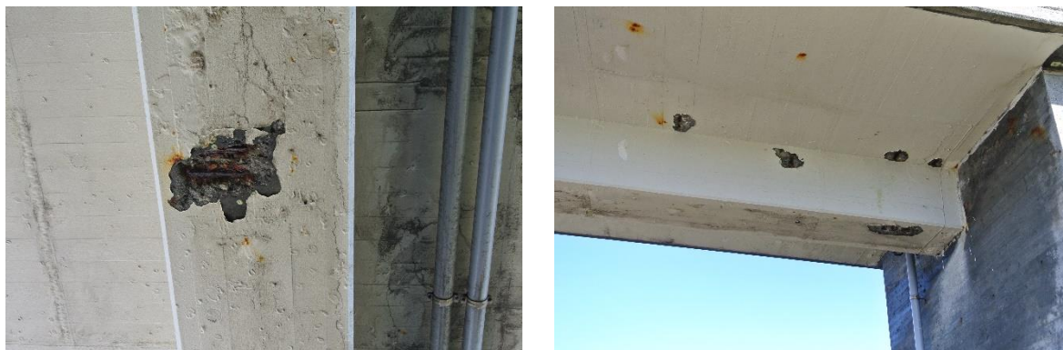
Figur 92: Punktskader på underside og side av brubjelke, samt punktskader på bruplate
