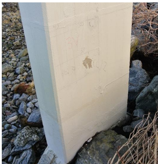
Figur 99: Uskadet overflate på søyle i Akse 3
