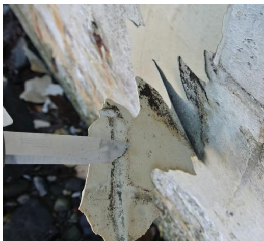
Figur 101: Avflakende belegg på høyresiden av fundamentet i Akse 4
