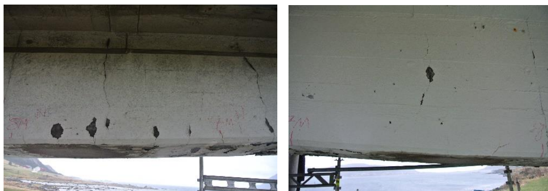
Figur 116: Riss på siden av bjelken mellom Akse 2 og 3 Venstre: Feltmidte av bjelke på nordsiden Høyre: Feltmidte av bjelken på sørsiden
