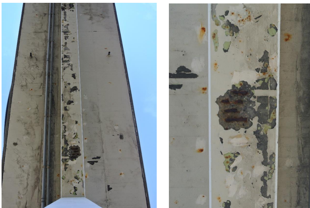
Figur 95: Omfattende avflaking og rustutslag på underside bruoverbygning i Felt 3
