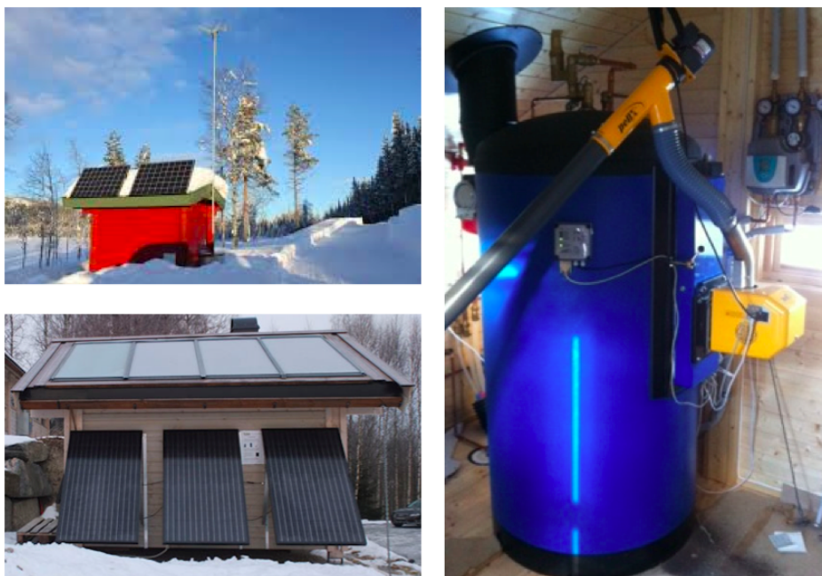
Figur 4.20: Øverst til venstre: Smart Energy Station® med solcellepanel og vindturbin [26]. Nederst til venstre: Energi-anneks med solceller på vegg og solfanger på tak [2]. Til høyre: Akkumulatortank for solfangeranlegg. Pelletsbrenner med tilhørende lager kobles inn i kaldere og mørkere tider av året [121].
