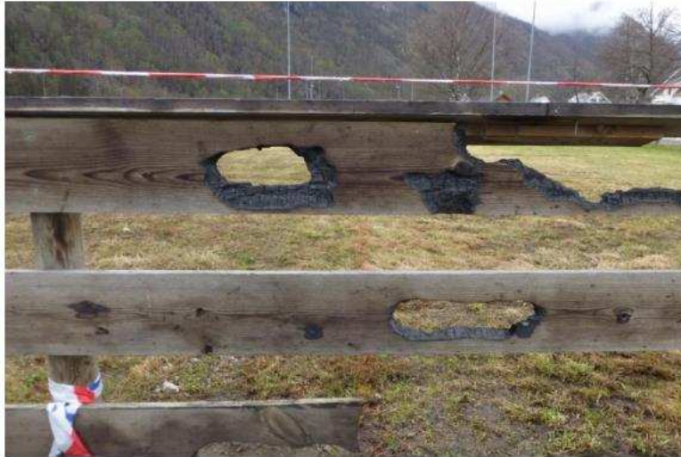
Figur 9: Skade på gjerde i østre enden av idrettsbanen [4]
