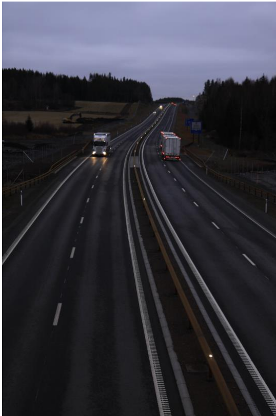
Figur 2 Ledelys med LED montert i rekkverk i midtdeler
