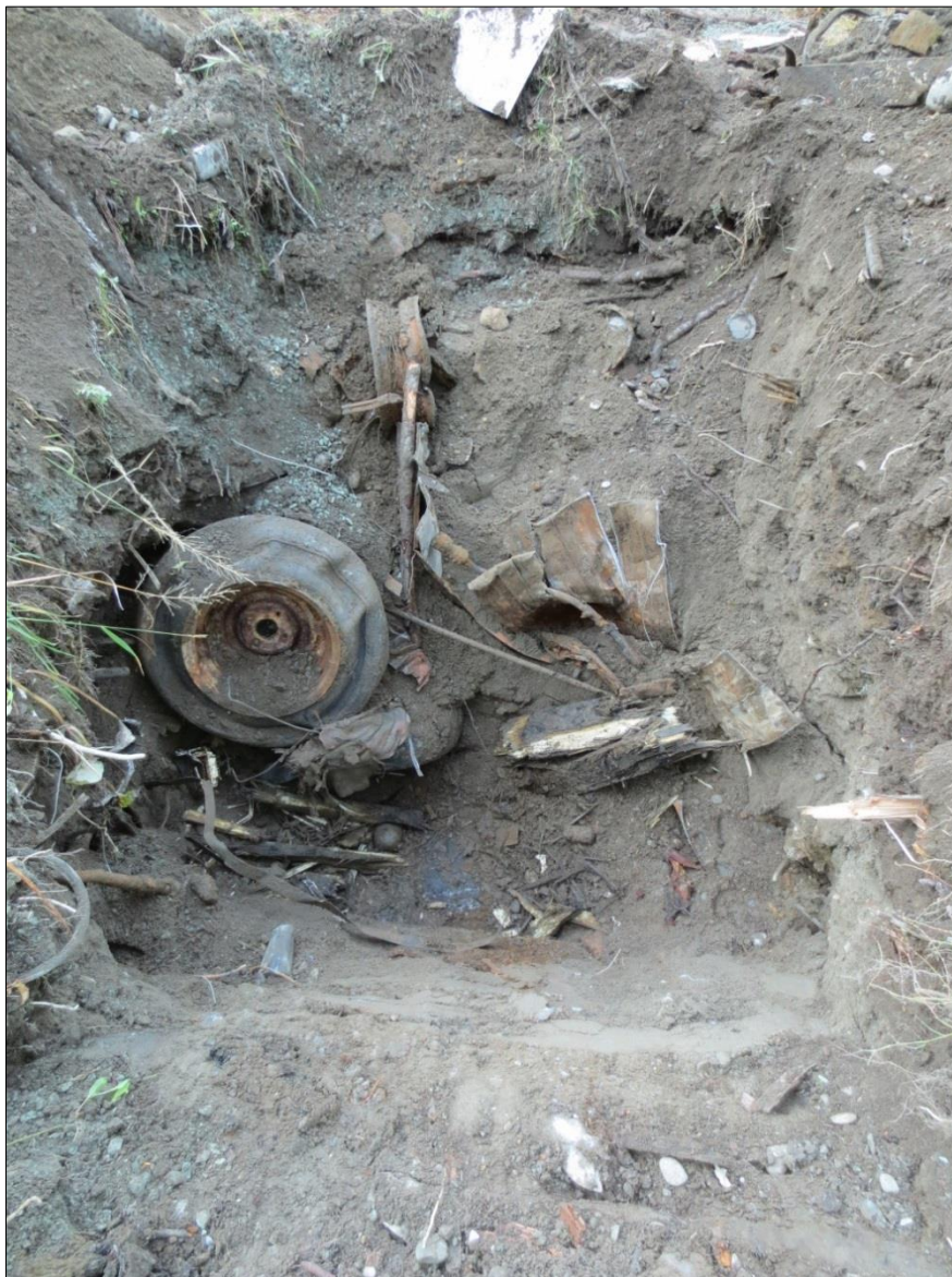
Figur 4.1.3: Et blikk ned i sjakt 1. Massene i sjakten besto hovedsakelig av sand, grus og skrot. Foto: privat.
