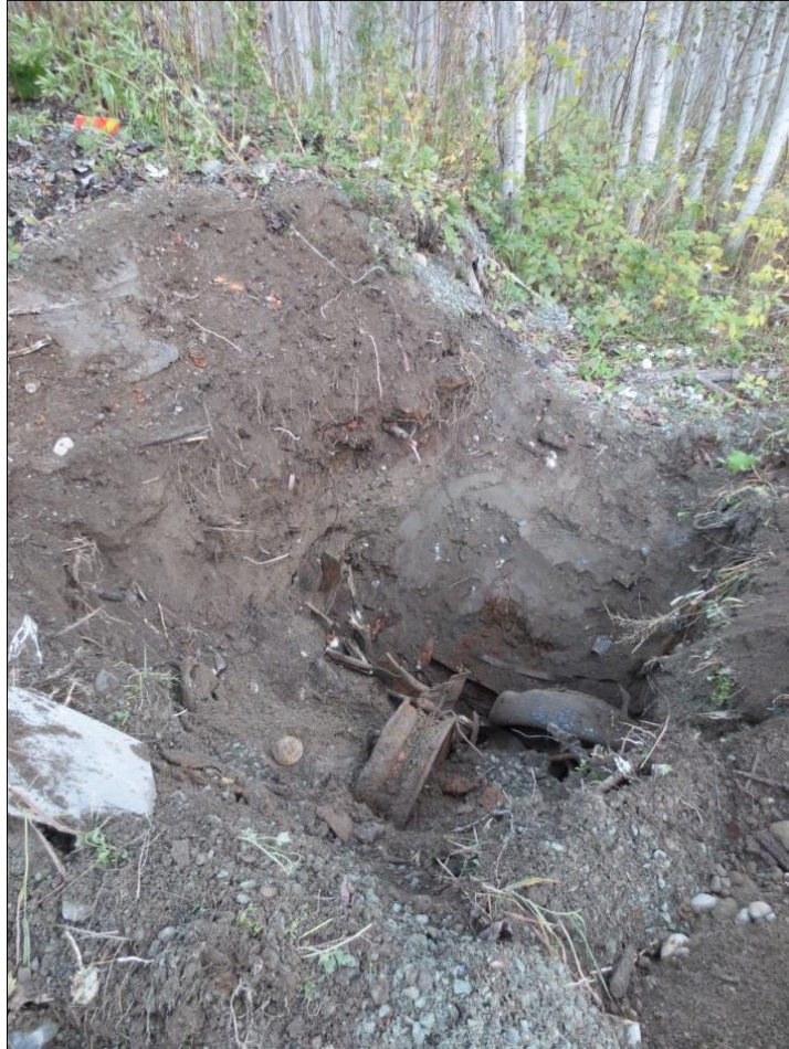
Figur 4.1.5: Blikk ned i sjakt 1, sett fra en annen vinkel. I Sjakten bakvegg kan man se større områder med oransjefargede masser. Foto: privat.
