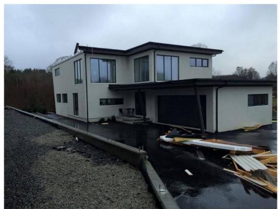
Det regnar rett inn i stova på det to år gamle huset til Rune Gerhardsen i 14-tida laurdag vart taket roska av, som følge av den kraftige vinden. FOTO: PIRVAT
