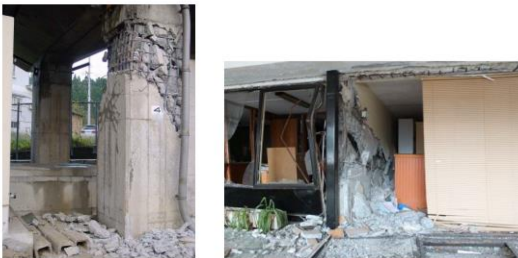
Figur 2.3.1: Eksempel på SD skadeomfang (Grøterud and Løset, 2013).
