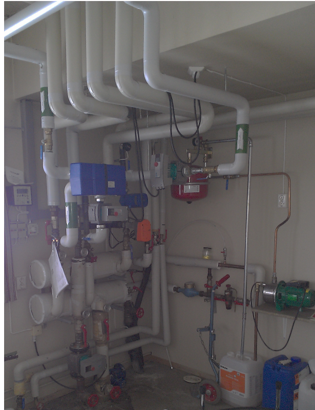
Figur 24: Fordeling av varmtvann til helse- og sosialsenter, lokalisert i vaskerom i kjøkkenfløy
