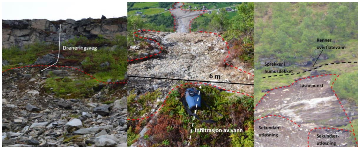
Figur 7.7: Til venstre er skredet i Viromdalen, midten er skredet ved Årset og til høyre er skredet ved Vatne. Som man kan se på figurene så har alle tre skredene synlig drenering inn under den øvre vegetasjonen via steiner eller sprekkesystemer.
