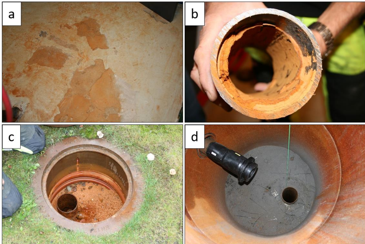
Figur 5.12 Rustutfelling i fire anlegg. a) Rustutfelling på gulvet i driftsrommet på Lenavegen 3, b) rustutfelling i returrøret på Melhuset, c) rustfarget brønnkum tilhørende returbrønnen på Oterholmgården, og d) rustfarget brønnkum tilhørende returbrønnen på Thoragården.
