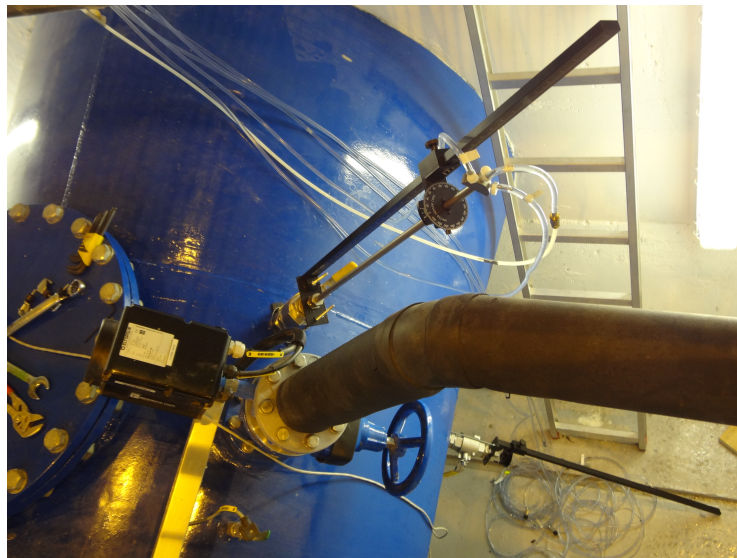
Figur 9: Pitot-rør installert ved Øvre Leirfoss.
