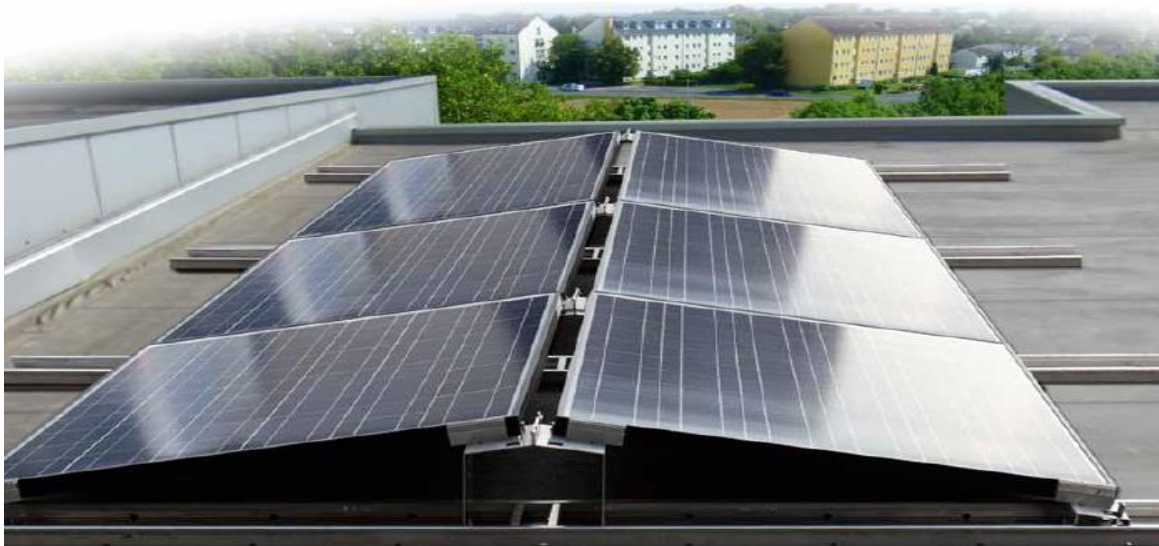
Figur 3-34 Monterte solcellepanel Powerhouse Kjørbo
