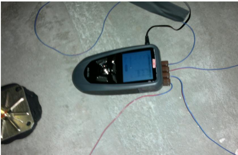
Figur 48 Datalogger fra Kimo, plassert i plenumet
