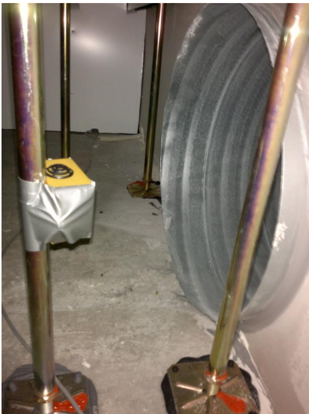
Figur 46 Måling av lufttemperatur inn til plenumet
