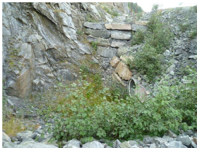
Figur 19. Eit av tre fordrøyningsbasseng ved E39 Renndalen - Staurset, Foto: Kvalsvik.
