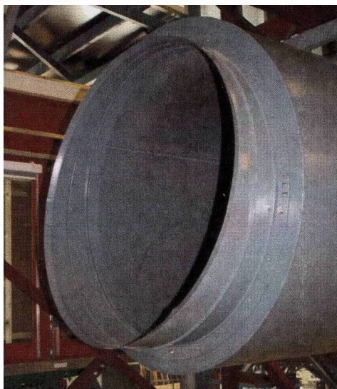
Figur 2.9: Innløpskonen som forårsaket separasjon ved innløpet. Kilde: [5]
