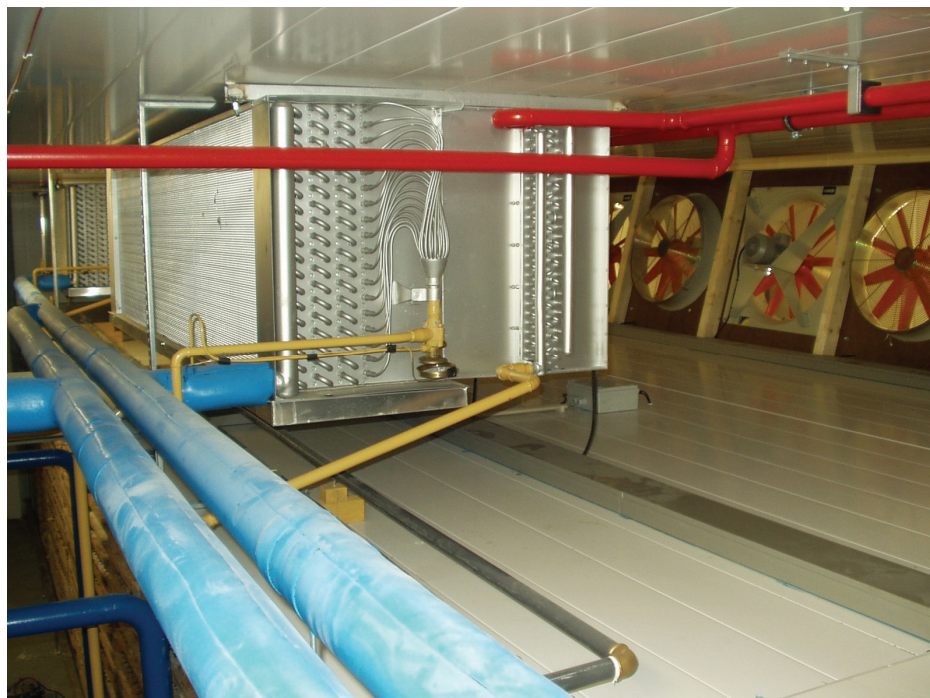
Figur 2. Luftbehandlingsaggregat oppe på himling
