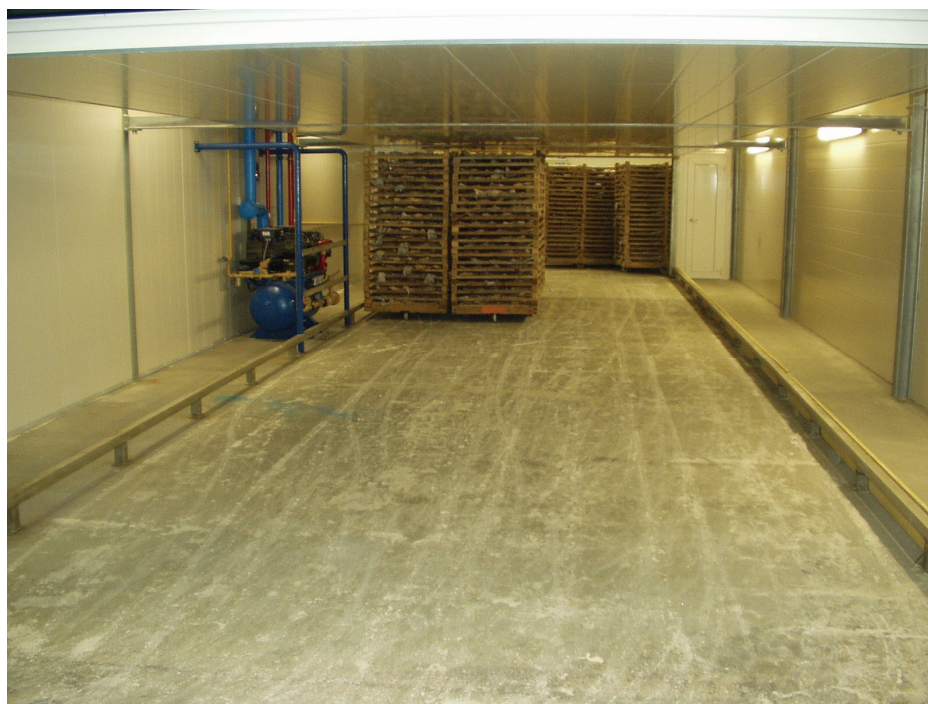
Figur 1. Tørketunnel sett fra utlastningsside
